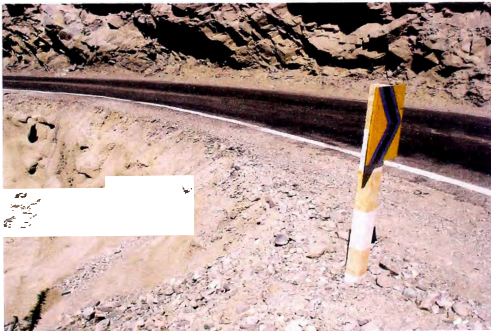
FOTO N° 2: Necesidad del muro de contención.
