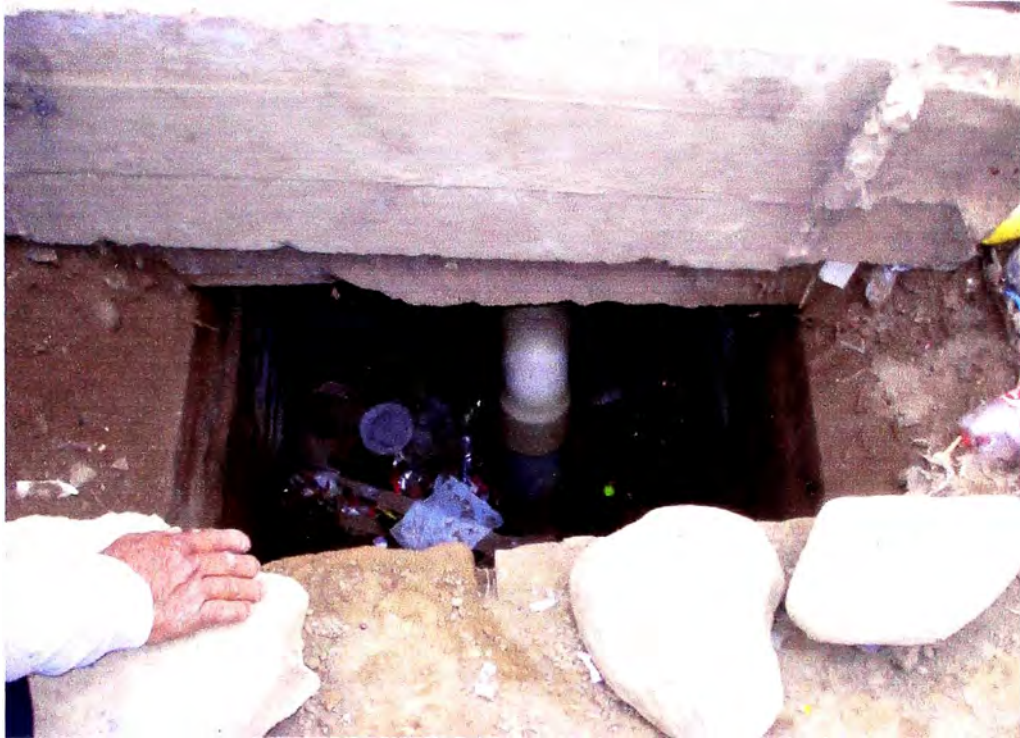
FOTO 7: ESTADO ACTUAL DE LAS INSTALACIONES DE AGUA
