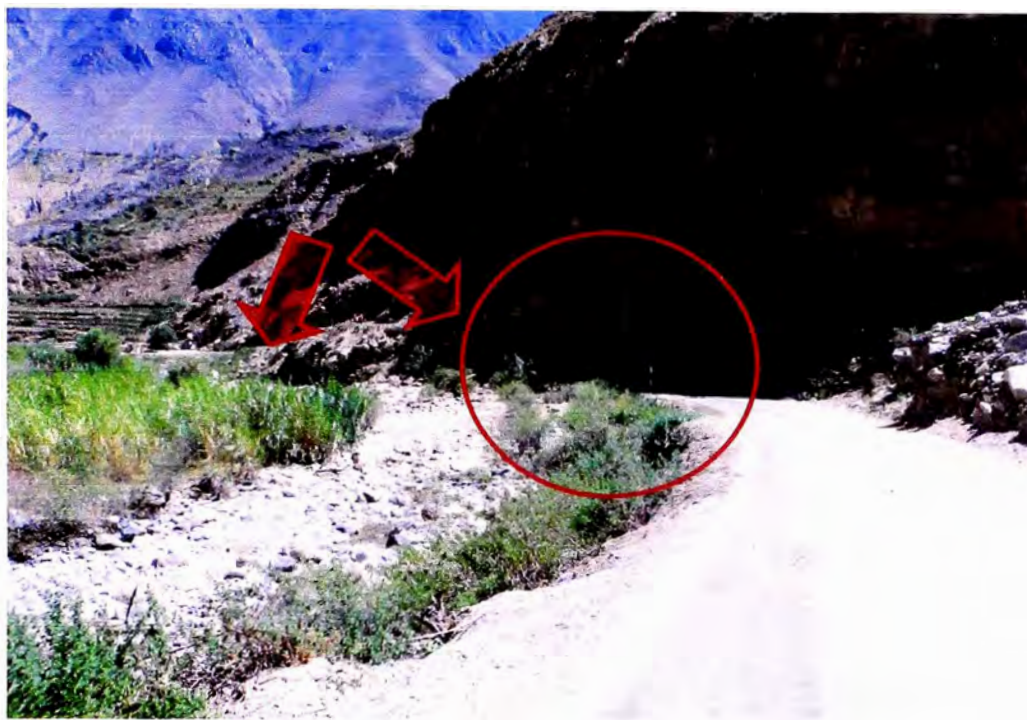
Foto N°13: En esta foto se puede apreciar un sector crítico muy cercano al río, ante una crecida del río se podría dañar la vía e imposibilitar el paso de los vehículos, Km 115+500.
