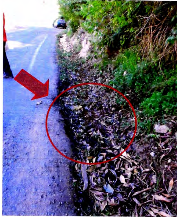
Foto N°15: La flecha indica que la cuneta no tiene mucha profundidad y también que se encuentra rellena por hojas y lodo, Km 114+080.
