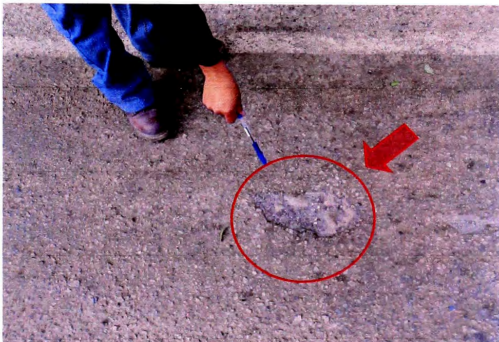
Foto N°08: En la foto se puede ver la grava descubierta debido al desprendimiento del asfalto, Km 114+840.
