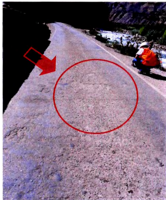
Foto N°06: Esta foto muestra el nivel elevado de desgastes en la que se encuentra la vía, Km 115+600.
