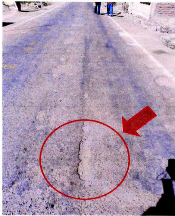
Foto N°05: En esta foto se puede apreciar el estado de deterioro en que se encuentra la vía, se observa desprendimiento del pavimento, Km 115+540.
