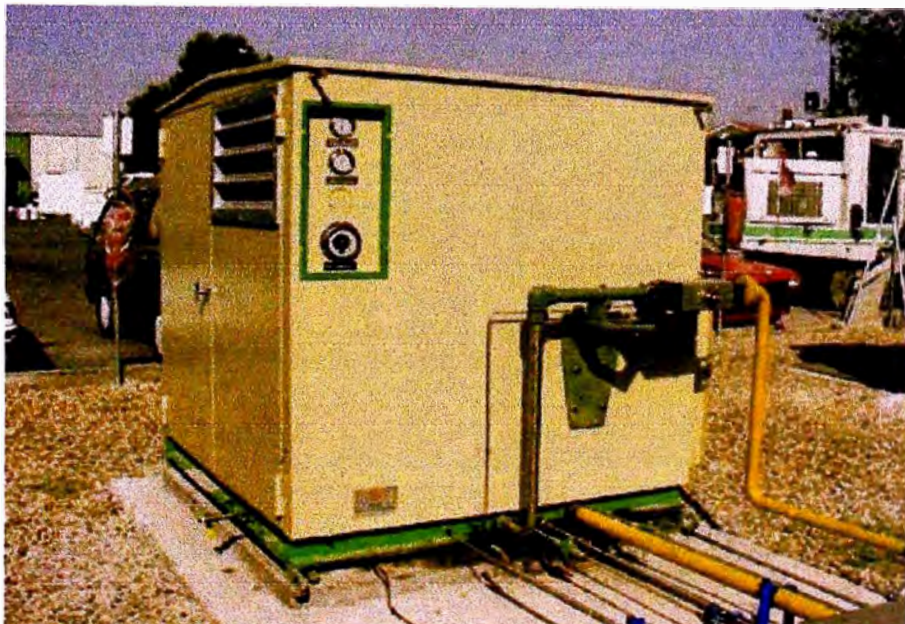
Cubogas N°2 Instalado en FCC Pozuelo (Madrid)
