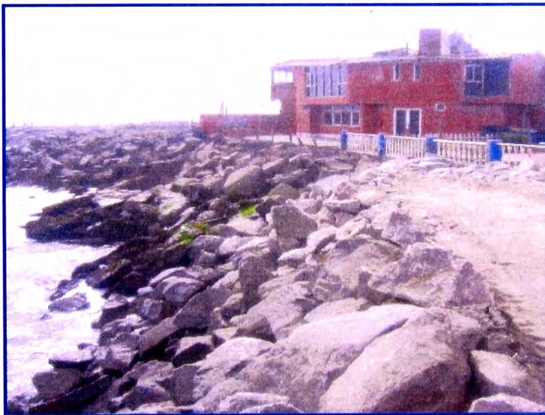
FIGURA N° 1.05 Erosión de la playa, formando taludes y gran pérdida de volumen de arena
