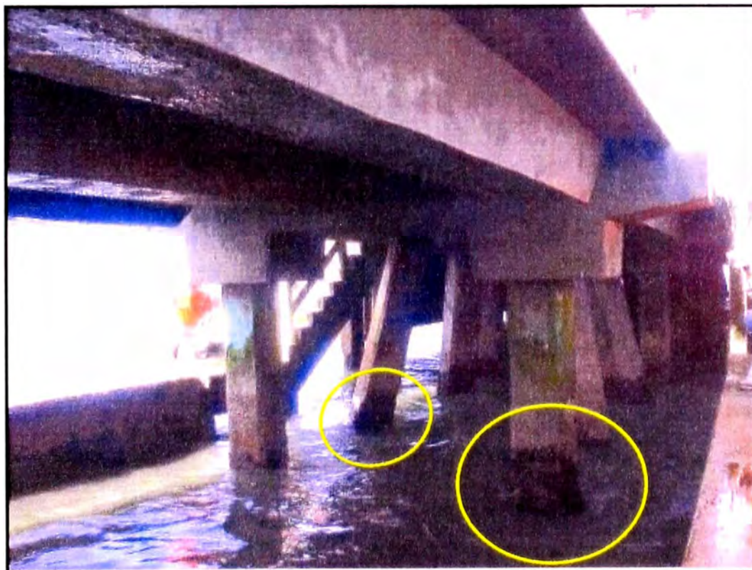
FIGURA N° 1.09 Otro tramo de desgaste del concreto en pilotes debido a la corrosión, en el muelle de pescadores del TPS
