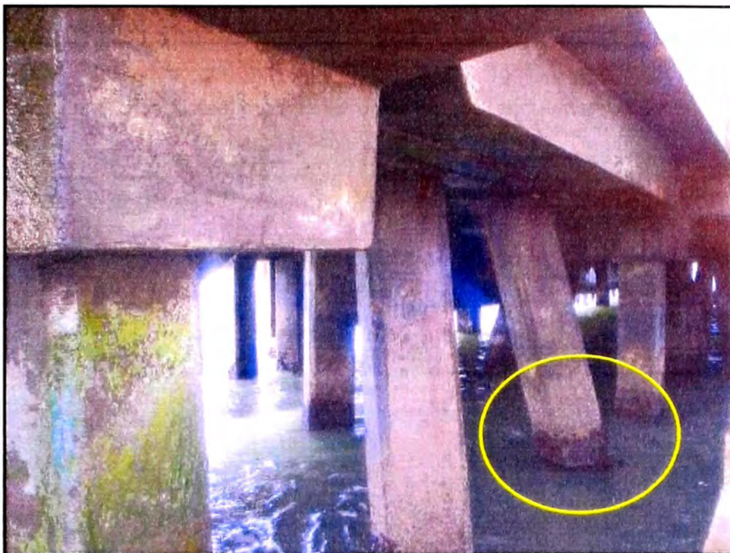
FIGURA N° 1.08 Desgaste del concreto en pilotes debido a la corrosión, ocasionado por el ambiente marino agresivo, acortando la durabilidad de la armadura de acero
