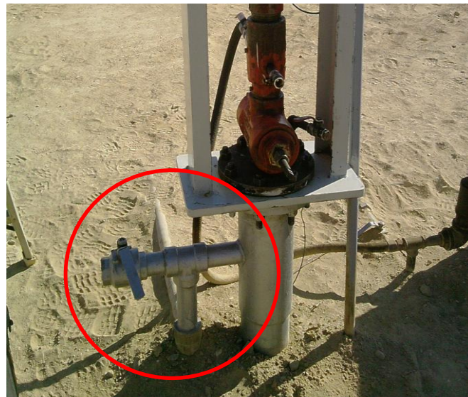
Fig. 7.9 Pozo EA9796: Carretel modificado para unir forros a la línea de flujo.
