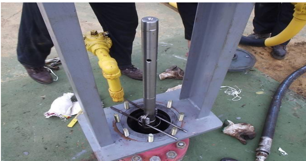
Fig. 6.6 Instalación Tubo de Aspiración de Acero Inoxidable
