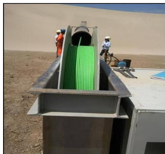
Fig. 2.20 Cable de Acero Revestido (Equipos Nuevos)
