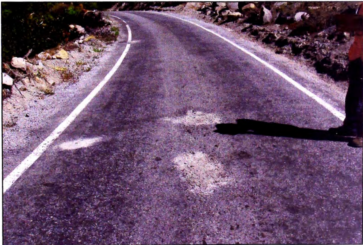
Se observa la desintegración y peladuras localizadas de la superficie de rodadura (monocapa asfáltica)
