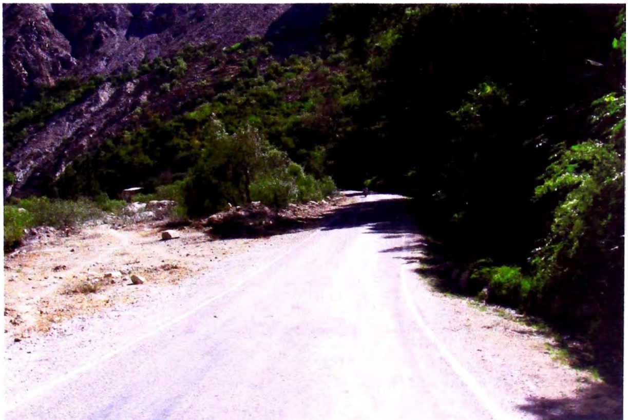
Se aprecia abundante vegetación en los taludes, lo que evidencia la presencia de humedad.
