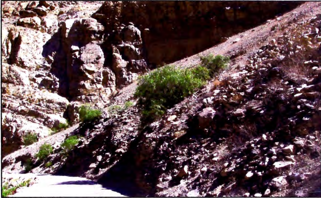
Se observa taludes con pendiente elevadas, con presencia de roca superficial que puede desprenderse hacia la calzada.
