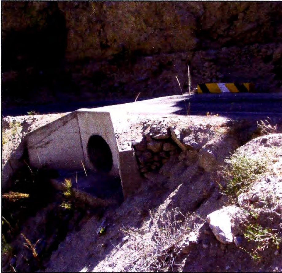
Presencia de alcantarillas TMC, para la evacuación del agua proveniente de las cunetas.
