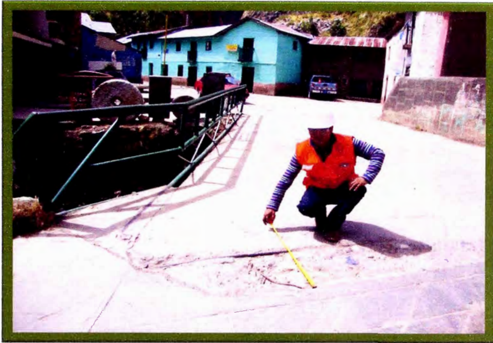
Foto N°07: No existe Junta de expansión, es la principal causa del deterioro de la losa.
