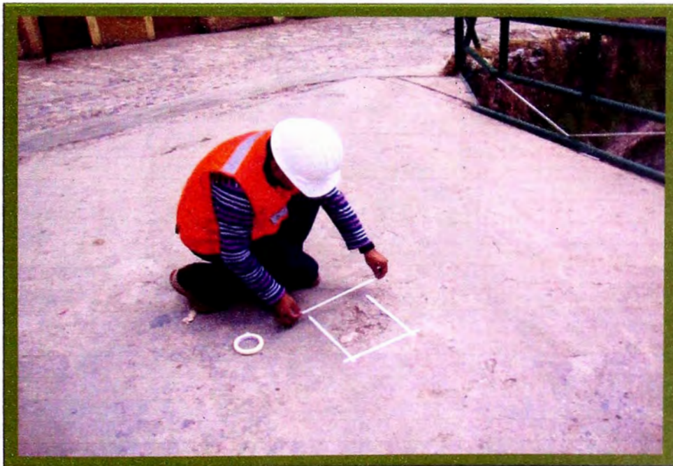
Foto N°08: Presencia de baches en la losa del pontón.
