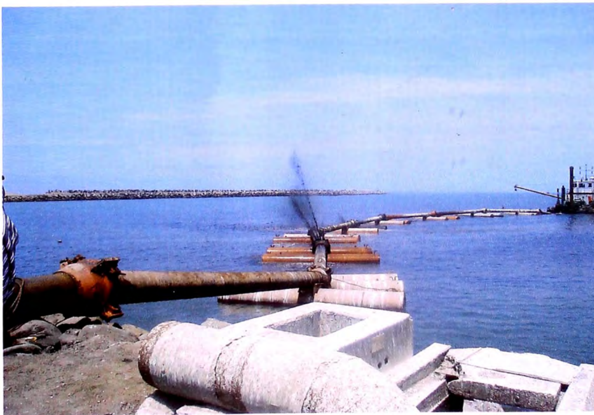
Se aprecia la fuga de la tubería del dragado, contaminando esta área del muelle
