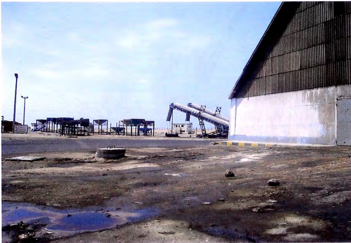
Se aprecia el ingreso al almacén de azúcar, contaminado por la melaza
