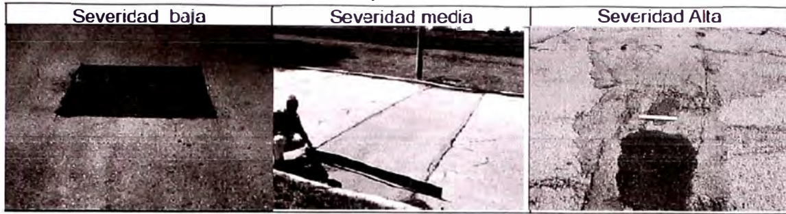
Foto N° 3.11 Falla Parcheo y Acometida de Servicios Públicos
