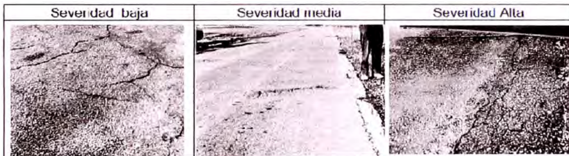
Foto N° 3.04 Falla Abultamientos y Hundimientos
