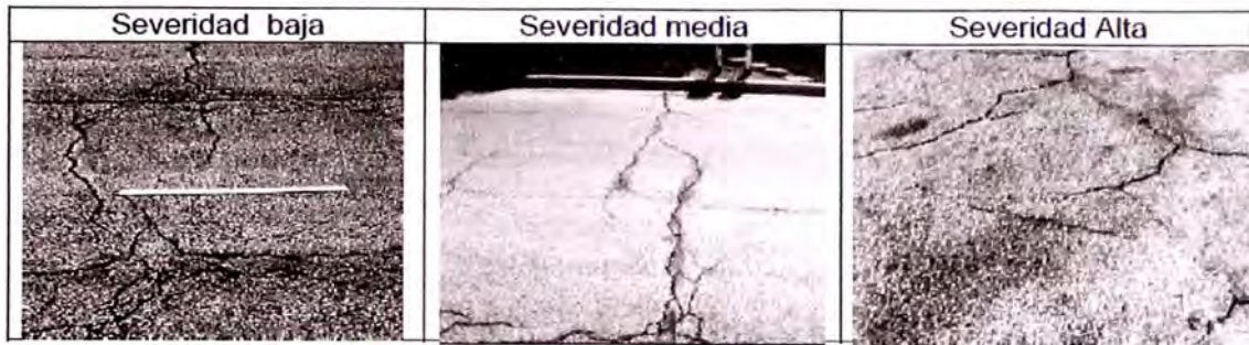
Foto N° 3.03 Falla Agrietamiento en Bloque
