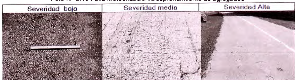
Foto N° 3.19 Falla Meteorización/Desprendimiento de agregados
