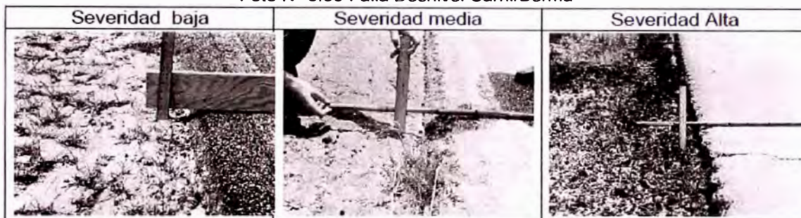
Foto N° 3.09 Falla Desnivel Carril/Berma
