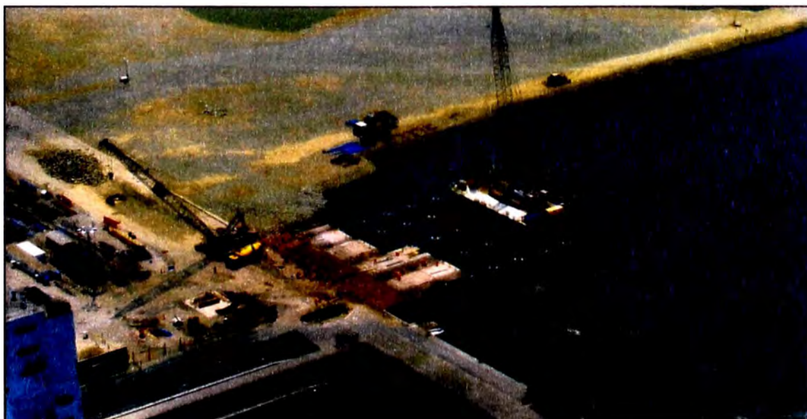
Foto N° 2.01: Trabajos de hincado de pilotes y colocación del tablero para el muelle
