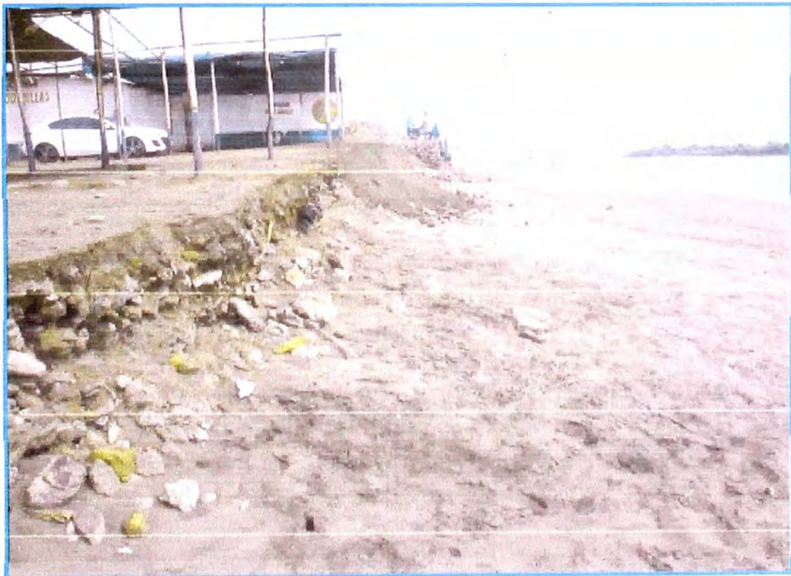
Fotografía N°1.01 Erosión de las playas al norte del Terminal Portuaria de Salaverry
