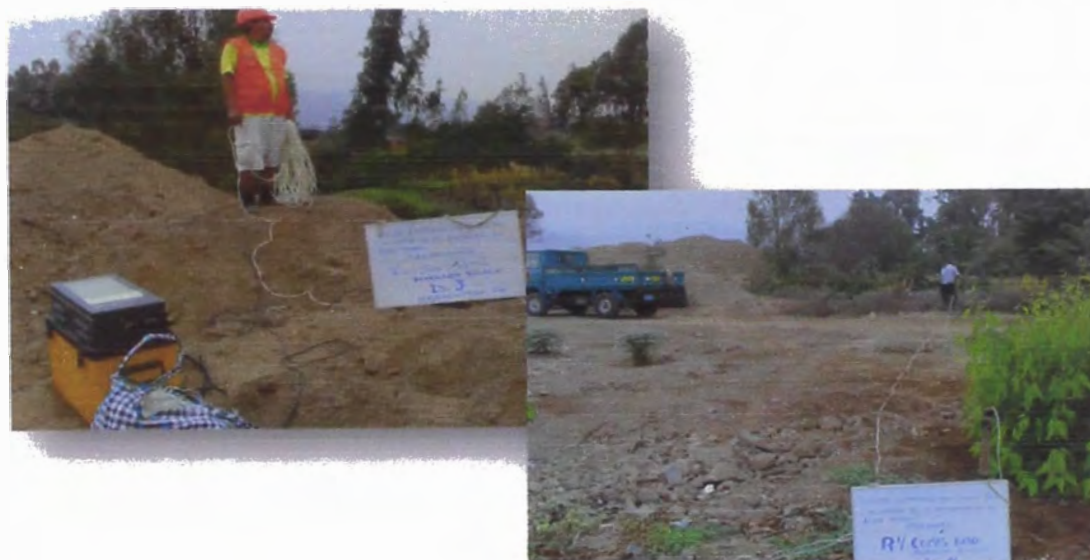
Foto N°8: Reservorio R4 Comas Bajo (Parque Sinchi Roca), líneas Ls 03 y Ls 04
