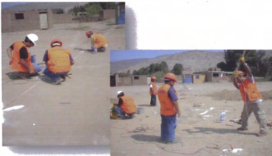
Foto N°4: Reservorio R1 – Jicamarca. Ls 02, instalación de la línea sísmica y ejecución del ensayo
