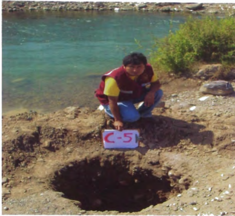
Calicata C-5: Esta calicata de 1.50 m de profundidad se realizo al lado del canal Nuevo Imperial en la zona donde se proyectara la estructura de captación.
