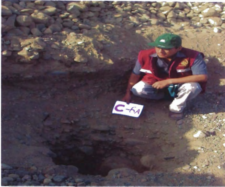
Calicata C-6A: Esta calicata de 1.50 m de profundidad se realizo en la zona donde se proyectara la planta de tratamiento.
