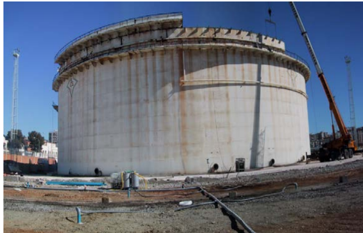
Fig. 3.1: Tanque de Almacenamiento de Crudo
