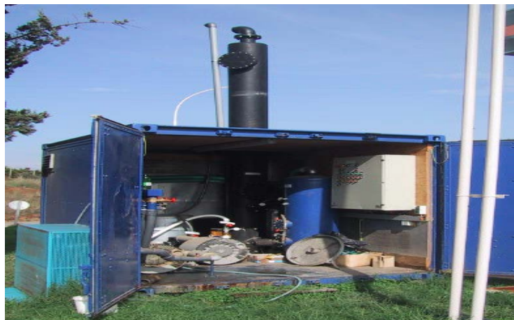
Fig. 3.15 Equipo de bombeo
