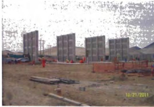
Fig. No. 2.9 Muros cortafuego
