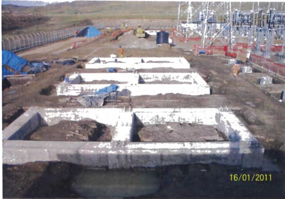
R.F. 14: Bases de patio de condensadores
