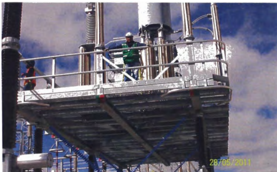
R.F. 25: Plataforma de condensadores-subestación eléctrica
