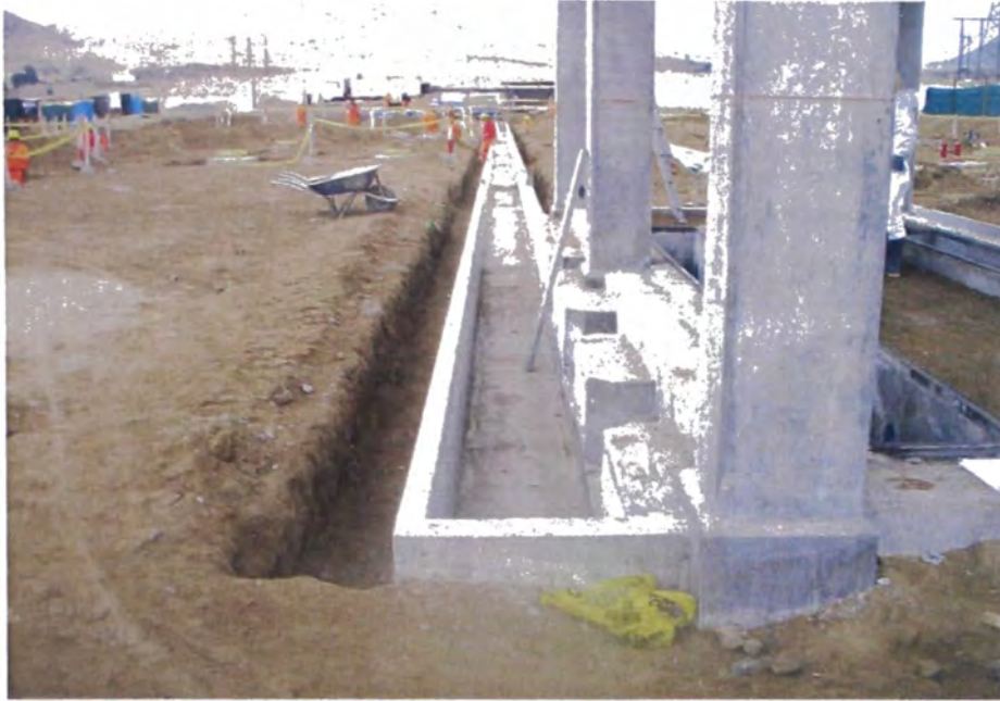
R.F. 11: Canaletas de entrega a caseta de control
