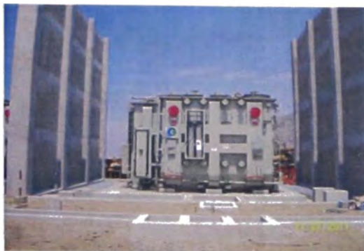
Figura No. 2.7 Base de transformador
