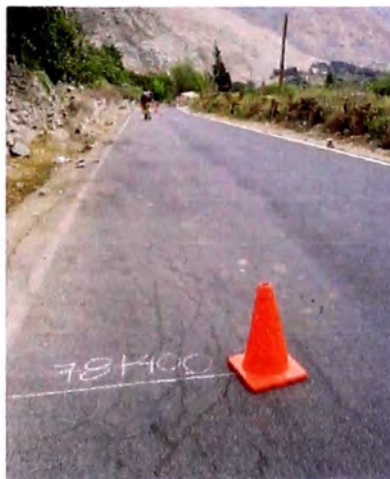
Figura N° 5.6: Fotografía de la progresiva 78+400, vista hacia Cañete en donde se ven fisuras longitudinales
