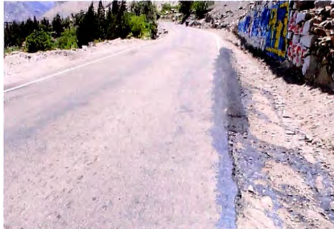
Figura N° 5.5: Fotografía de la progresiva 78+000, vista hacia Catahuasi, tratamiento con Slurry Seal en donde se observan peladuras
