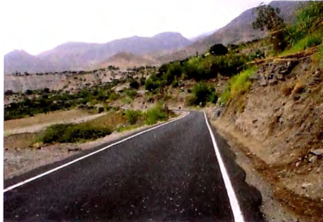
Figura N° 5.8: Fotografía de la progresiva 80+000, vista hacia Chupaca, se aprecian peladuras y desintegración superficial
