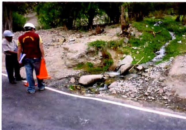
Figura N° 5.9: Fotografía de la progresiva 80+600, tratamiento monocapa + Slurry Seal, en donde se observa ondulaciones de la vía debido a la existencia de un sistema de drenaje
