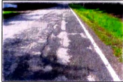
Figura N° 5.10: Perdida de agregados
