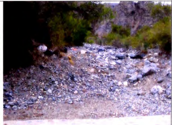
Foto 12: Badén necesario por los deslizamientos en el cono de inyección cercano, Km 136+200 al Km 136+300.
