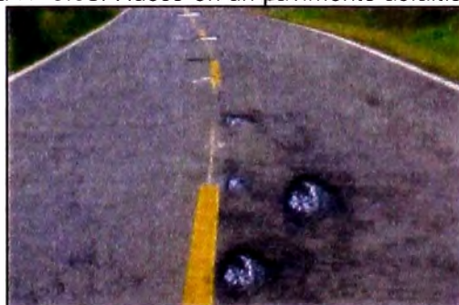
Figura N° 5.08: Huevo en un pavimento asfáltico
