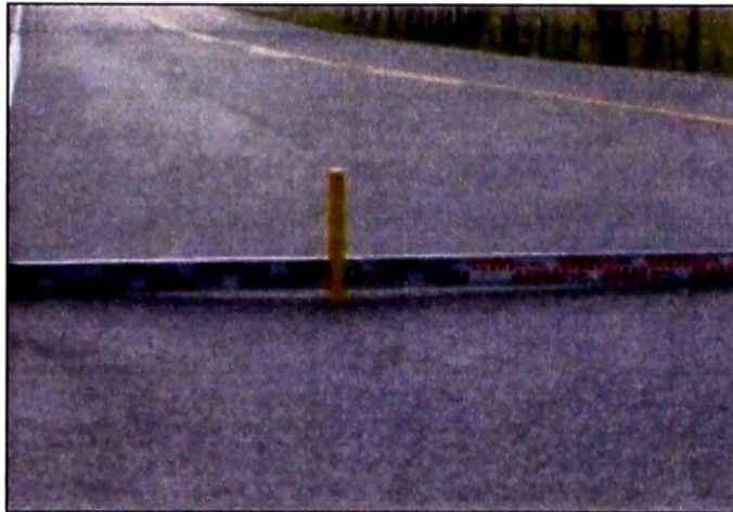
Figura N° 5.06: Ahuellamiento de un pavimento asfáltico
