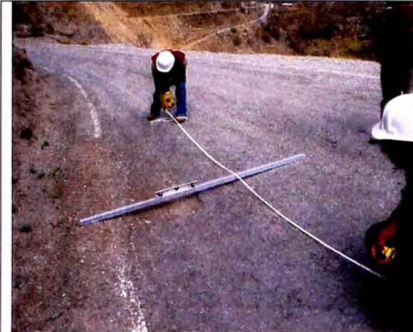
Foto 08: Toma de medida de datos, análisis de la falla y mediciones respectivas (Piel de cocodrilo) Km 135+500 al Km 135+600
