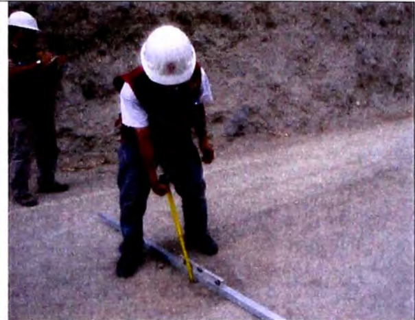
Foto 09: Toma de medida de datos, análisis de la falla y mediciones respectivas (Huecos) Km 135+800 al Km 135+900
