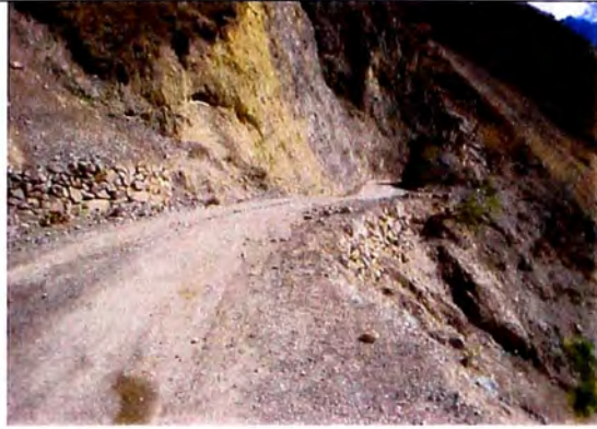
Foto 06: La vía requiere de limpieza para poder evitar que los daños se agraven, Km 135+400 al Km 135+500.
