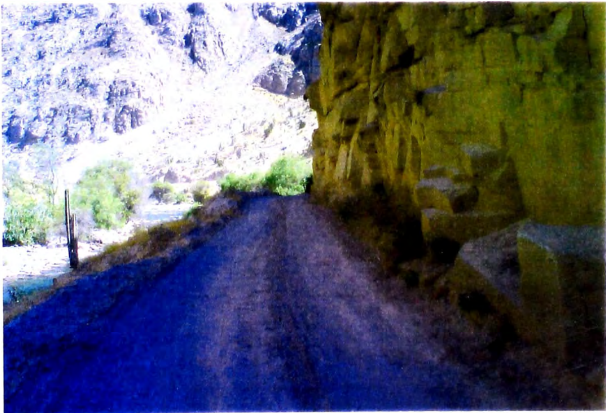
FIGURA N°2.6 SUPERFICIE DE RODADURA NO PAVIMENTADA.
