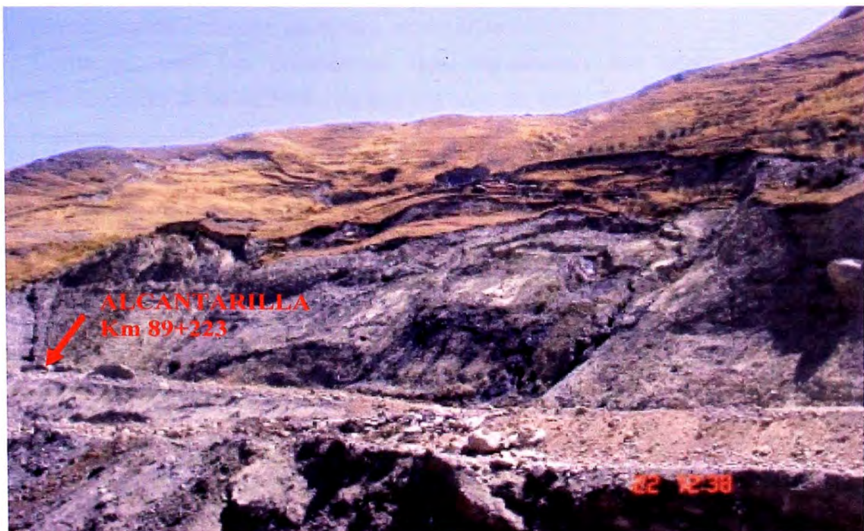
Foto N° 2.7 El cambio de trazo, como una de las soluciones para salvar el derrumbe del Km 89 mostrado en la foto, afecta la alcantarilla del Km 89+223 ya ejecutada.
