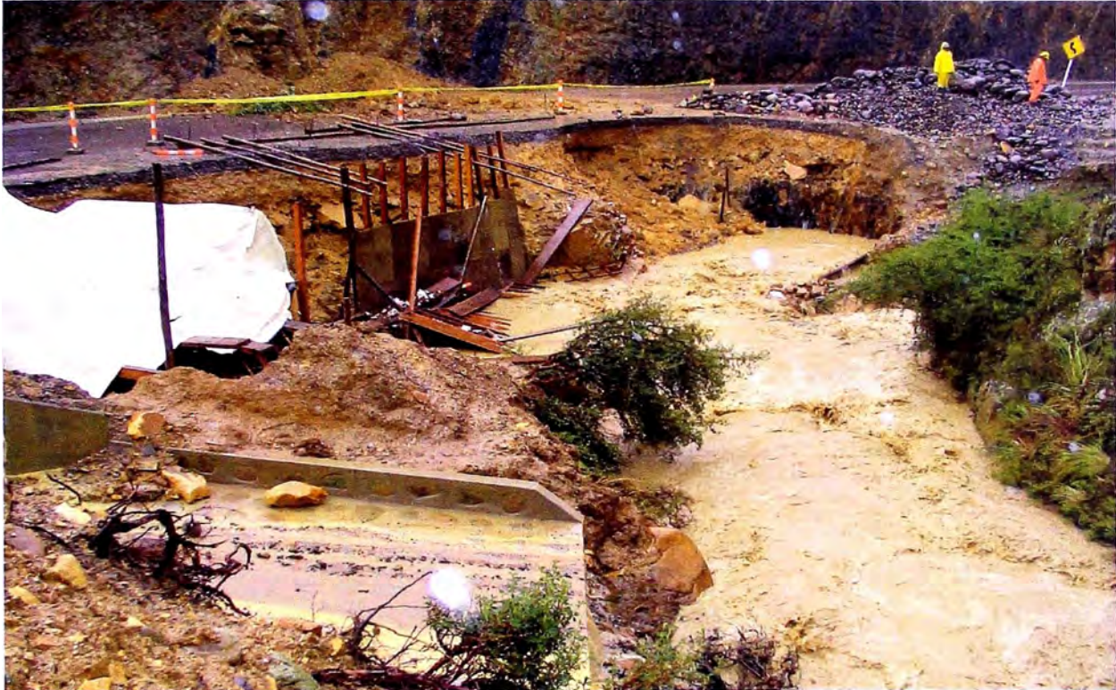
Foto N° 5. Erosión a la altura del Km 52. Las precipitaciones sorprendió la construcción del muro de concreto ocasionando los problemas mostrados.
