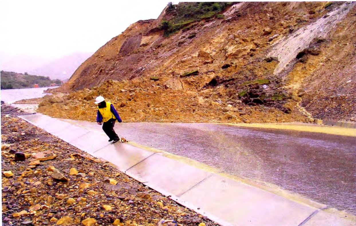
Foto N° 6 Problema de derrumbe a la altura del Km 52. Las lluvias incrementaron la desestabilización de los taludes de la plataforma de la vía.
