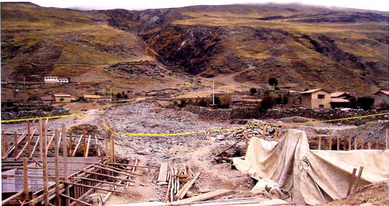
Foto N° 2.5 Construcción del pontón del Km 84+135.6, mostrando la topografía de la quebrada y las viviendas aledañas al curso principal.
