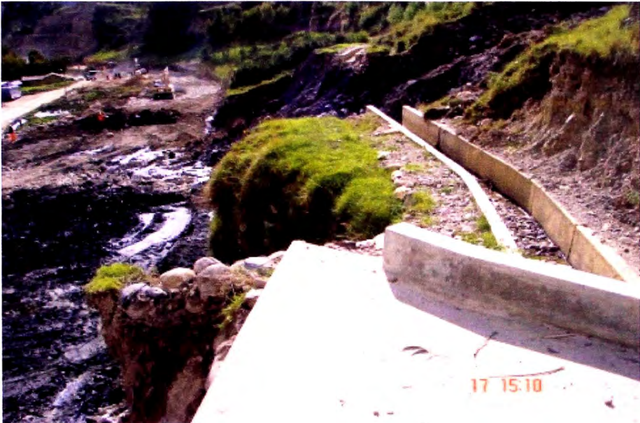
Foto N° 2.2 Zona de derrumbe del Km 77+990 al Km 78+100, con canal de riego destruido.
