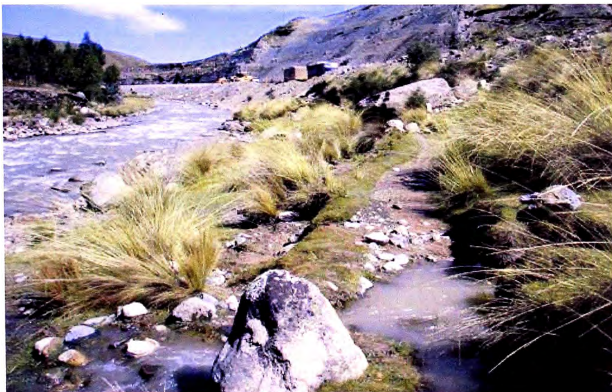
Foto N° 2.6 Río Mapacho a la altura del Km 86 mostrando el canal de tierra destruido por la construcción de la carretera vista en ultimo plano de la foto.
