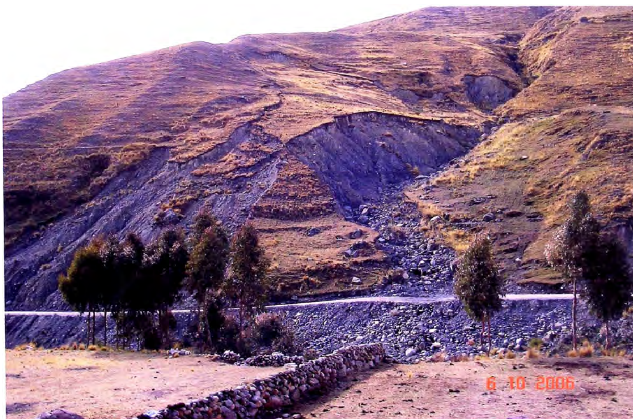
Foto N° 4. Taludes erosionados y quebradas de fuerte pendiente a la altura del Km 89, característica típica de esta parte de la vía.
