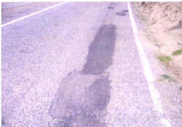
Figura N° 3.01. Grietas de borde
