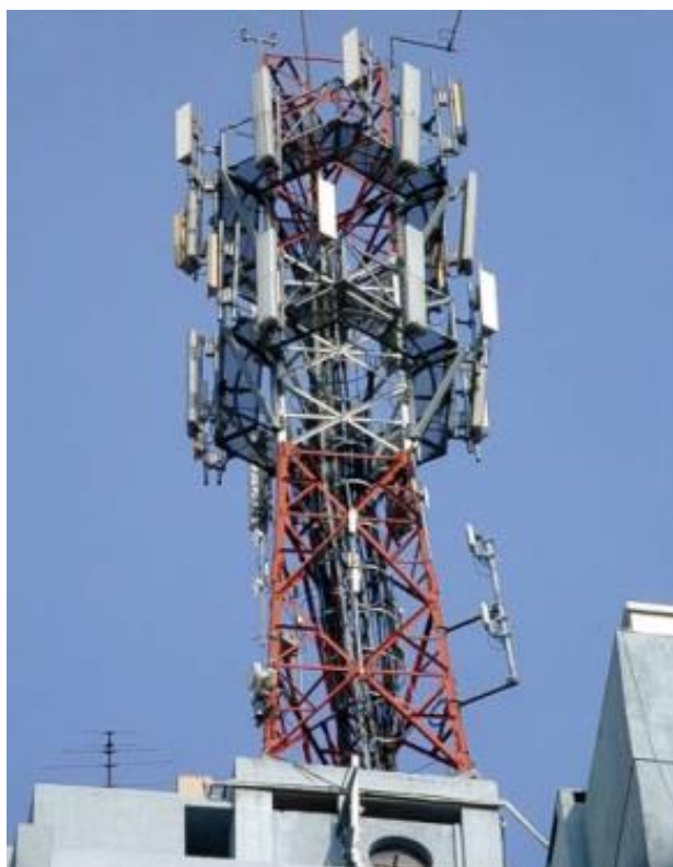
Figura 4. Emplazamiento conjunto de antenas de telefonía móvil
