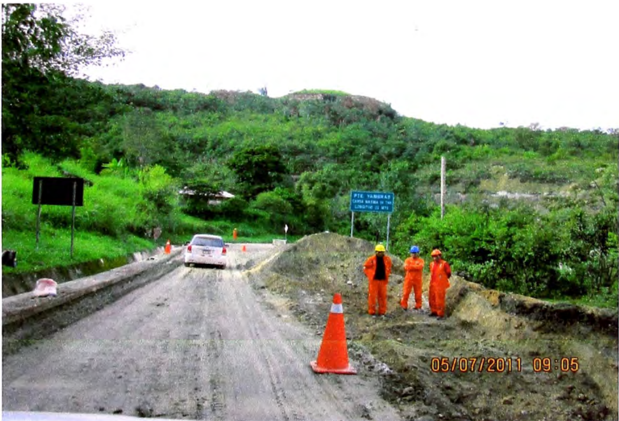
Km 338 Vista de un hundimiento de la carretera
