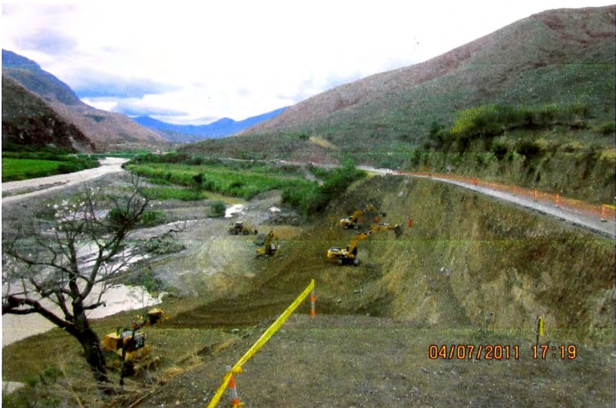
Km 108 Vista de un derrumbe del tramo de la vía
