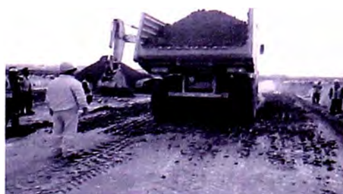
Foto N° 4.35: Transporte del material mezzado hacia el tramo de Prueba (Acceso Nuevo – Vivienda de operadores)
