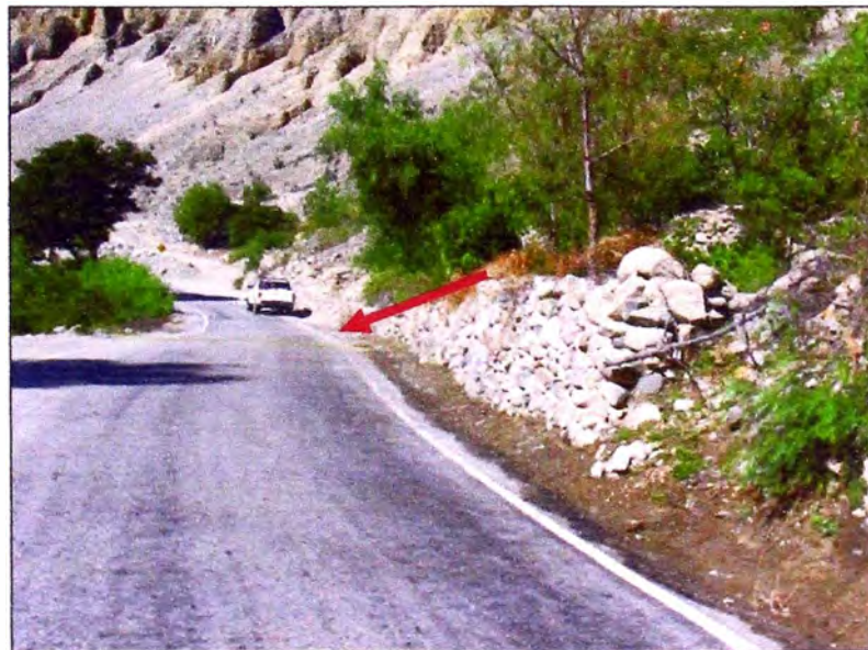
Figura N°1.05 Giba del Km 105+475
