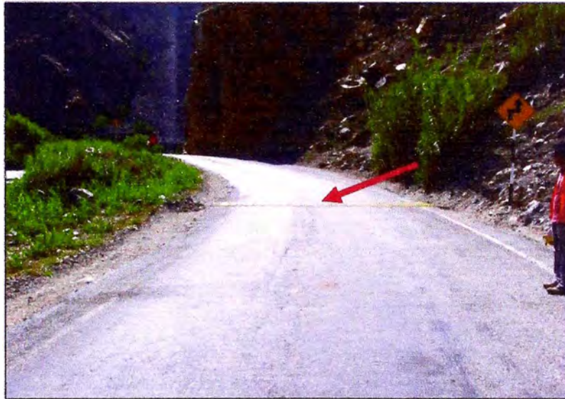
Figura N°1.04 Giba del Km 104+462
