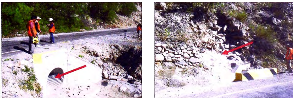
Figura N°1.07 Alcantarilla TMC 48" y piedra emboquillada en ingreso de ALC
