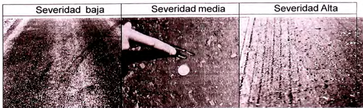
Foto N° 2.02 Exudación del Asfalto
