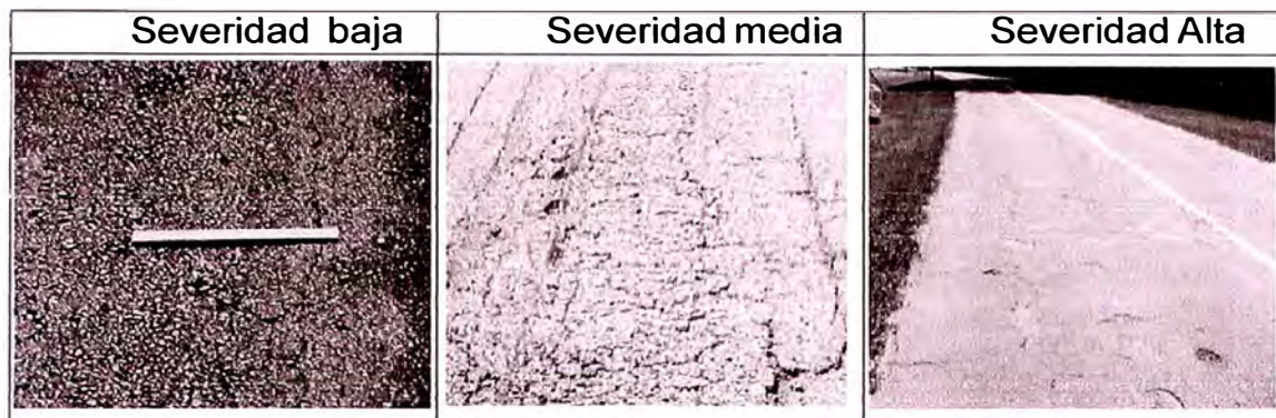
Foto N° 2.19 Disgregación y Desintegración
