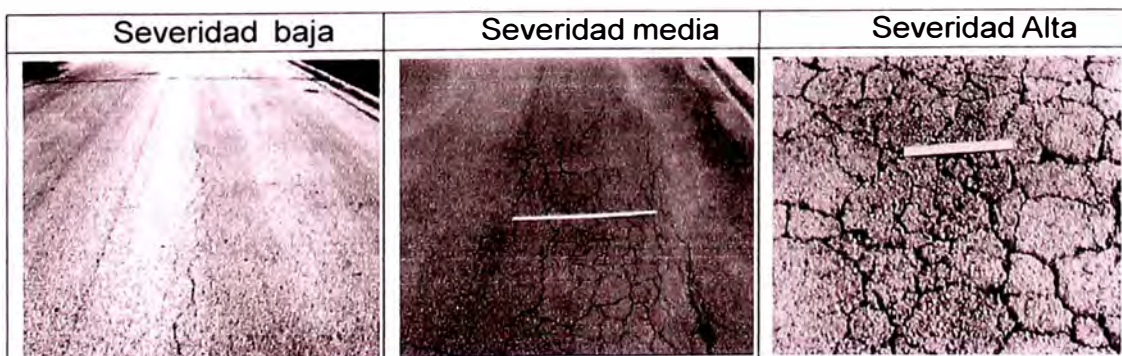
Foto N° 2.01 Grieta Piel de Cocodrilo
