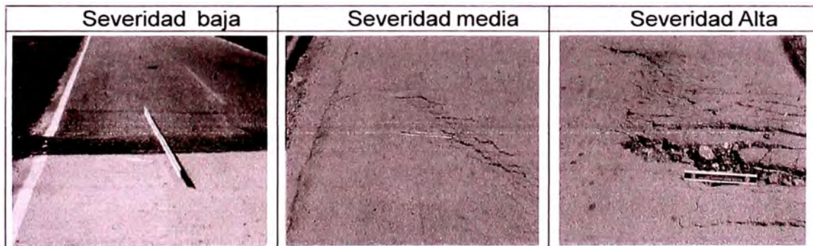
Foto N° 2.17 Grietas por Deslizamiento
