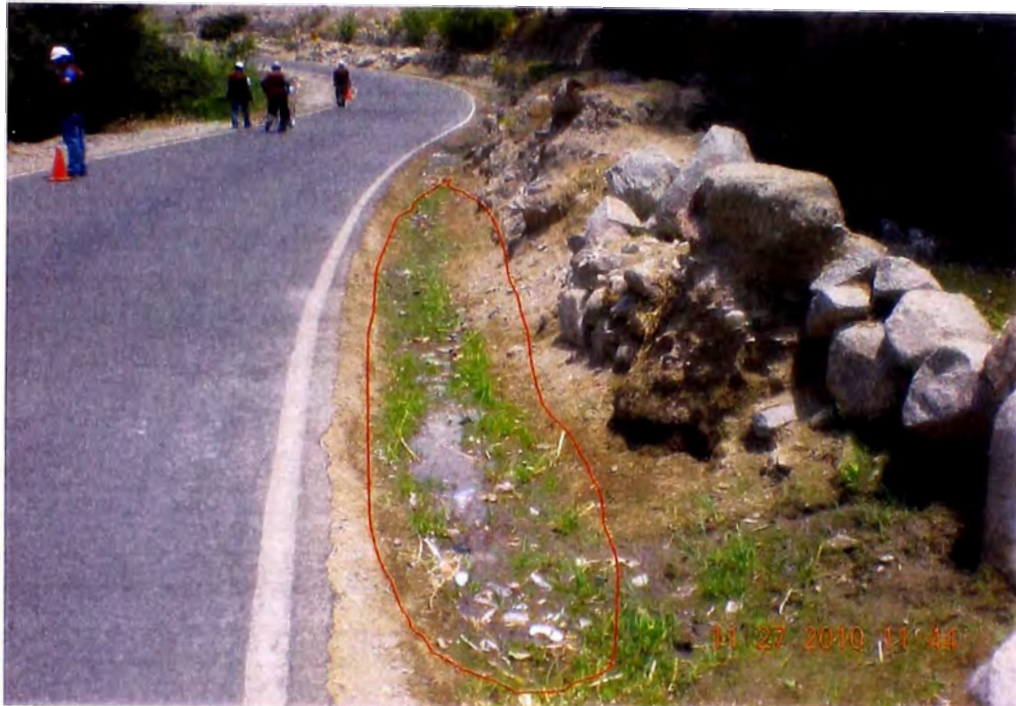
Mal drenaje por obstrucciones
