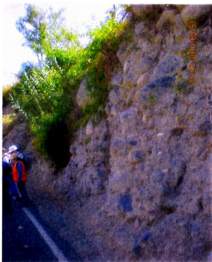
Talud vertical propenso a derrumbes
