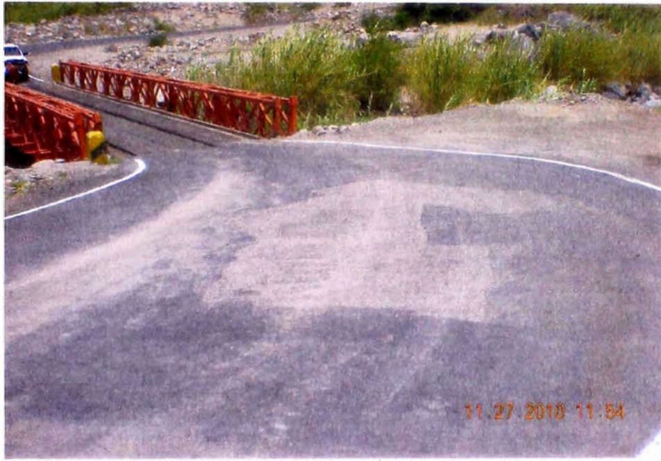
Falla en curva
