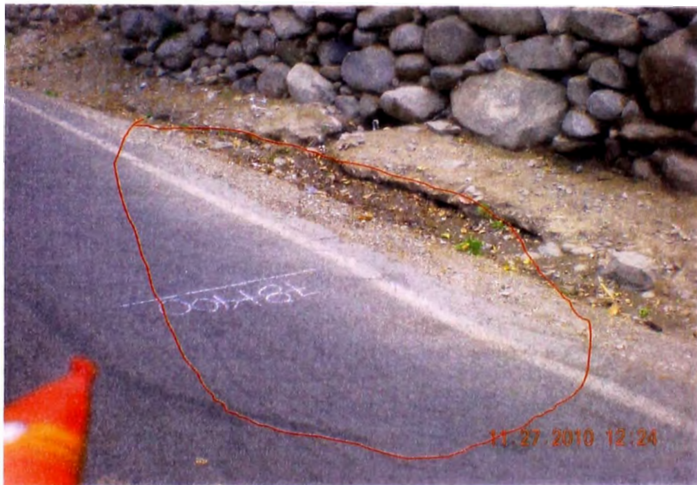
Hundimientos por mal drenaje
