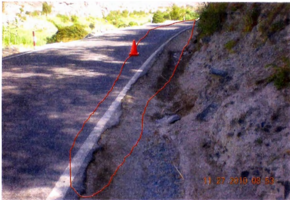
Falla de borde
