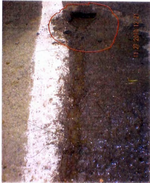
Emanación de agua evidencia problema de drenaje.
