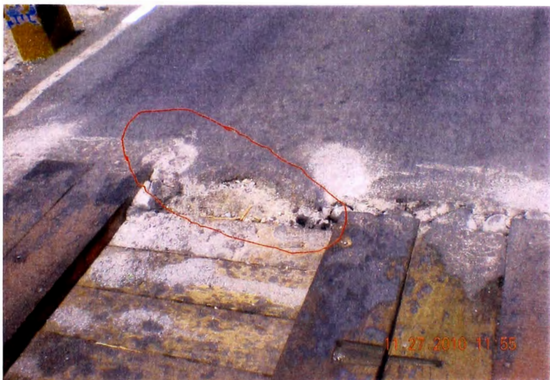
Falla en encuentro con puente
