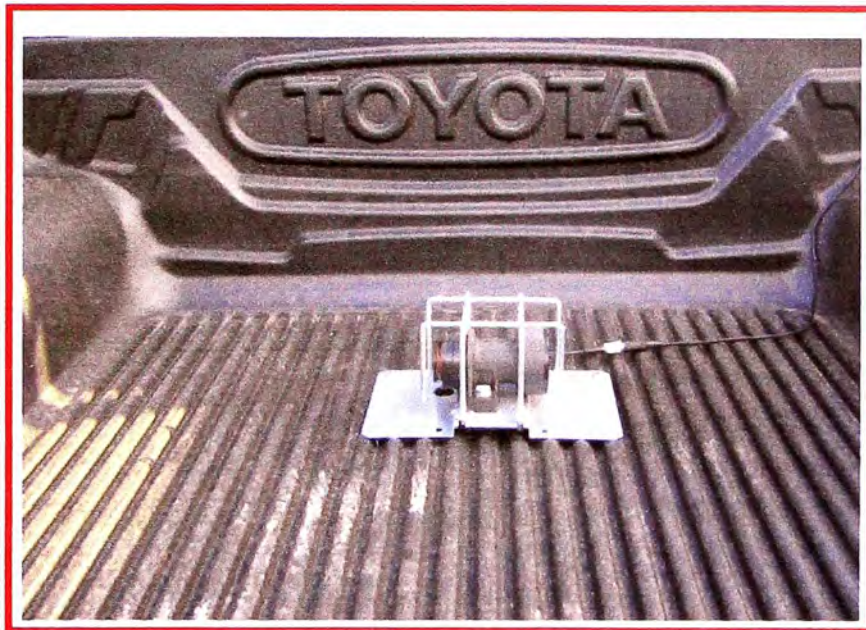
Figura N° 4.02: Instalación del Sensor de Desplazamientos
