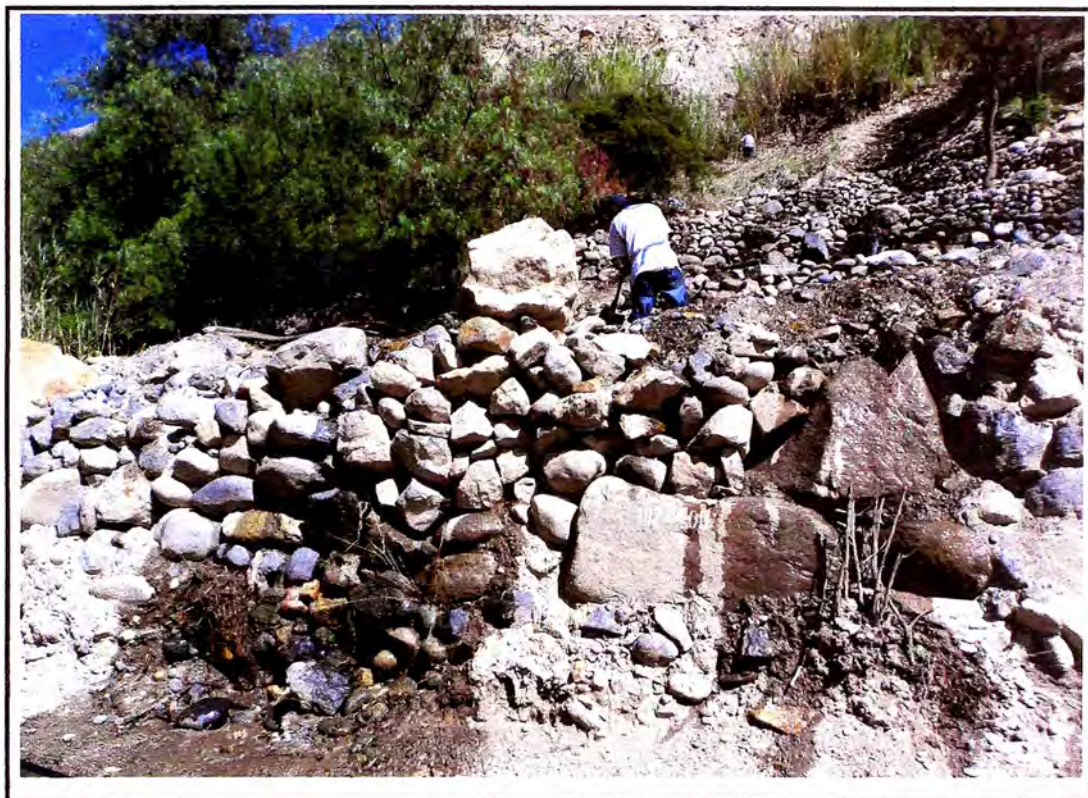
Fotografia N° 09: Filtraciones de Canal de Piedra Km.102+400
