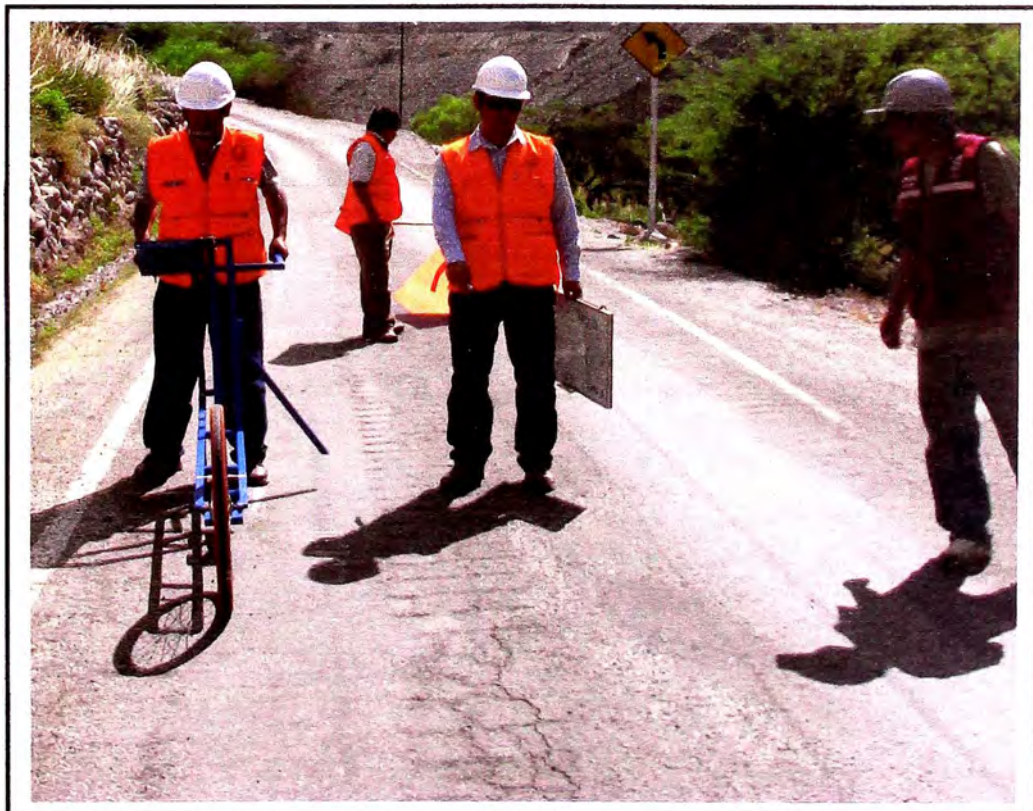
Fotografia N° 08: Presencia de Fisuras Km. 101+400
