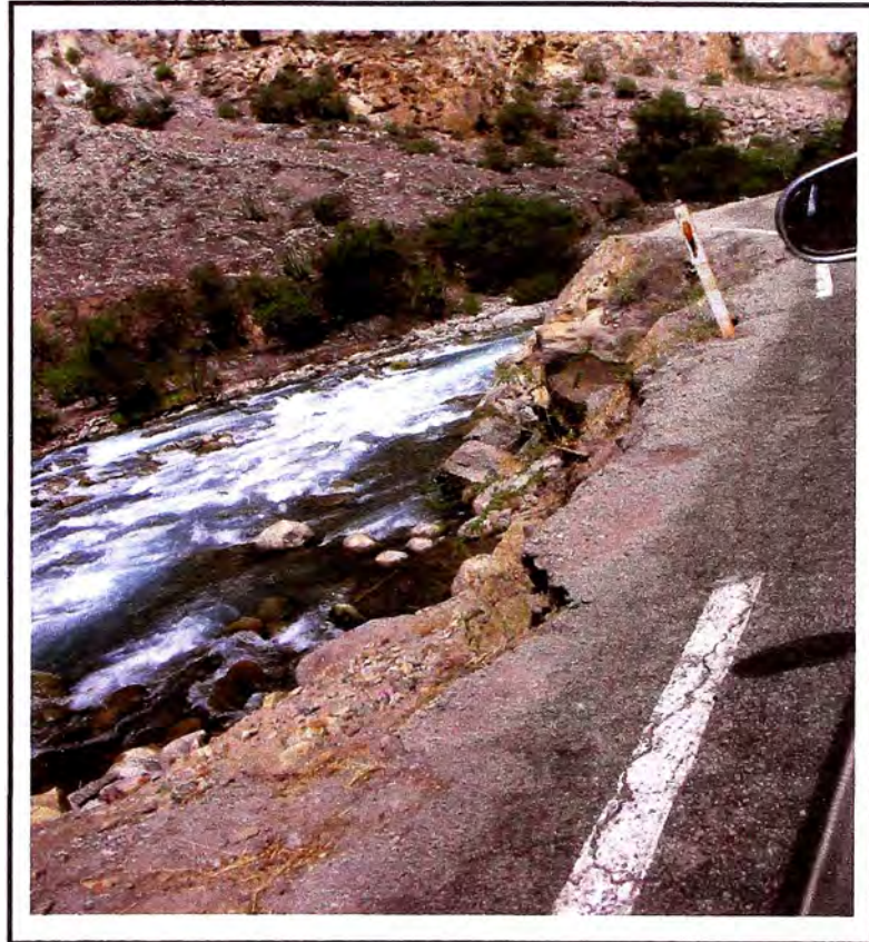
Fotografia N° 07: Zona Critica Sector Erosionado
