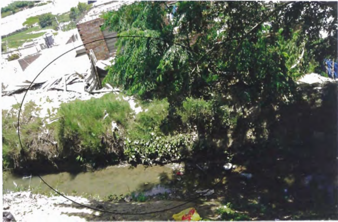
Foto N° A.9: Se muestra que el canal de regadío, en épocas de subidas de nivel afectan las viviendas cercanas, esto por acumulación de residuos de sólidos.
