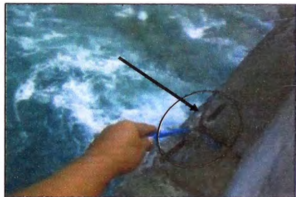
Foto N° 3.26, Inspección Daño Guardavía
