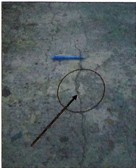
Foto N° 3.16, Inspección Losa Grietas
