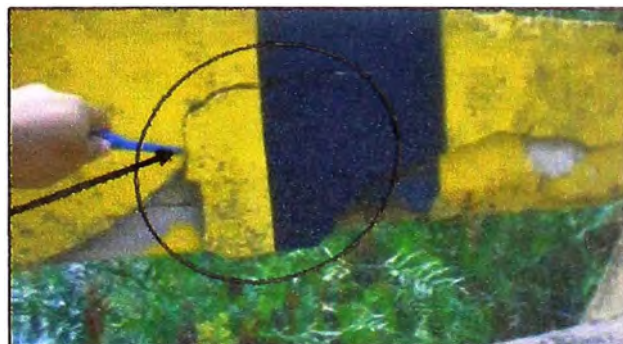
Foto N° 3.27, Desprendimiento del Recubrimiento
