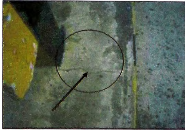
Foto N° 3.24, Inspección Veredas grietas
