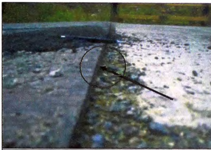
Foto N° 3.22, Asentamiento de la Plataforma
