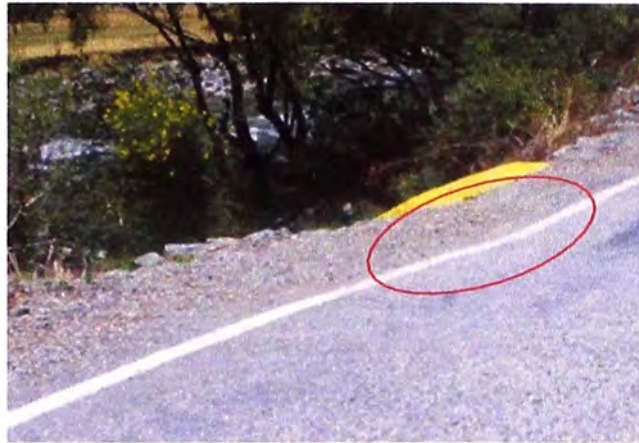
Figura N° 4.03: Ejemplo hundimiento severo.
