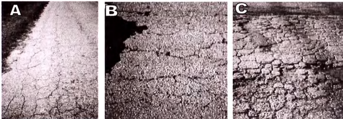
Figura N° 4.05: Ejemplo grieta de Cocodrilo
