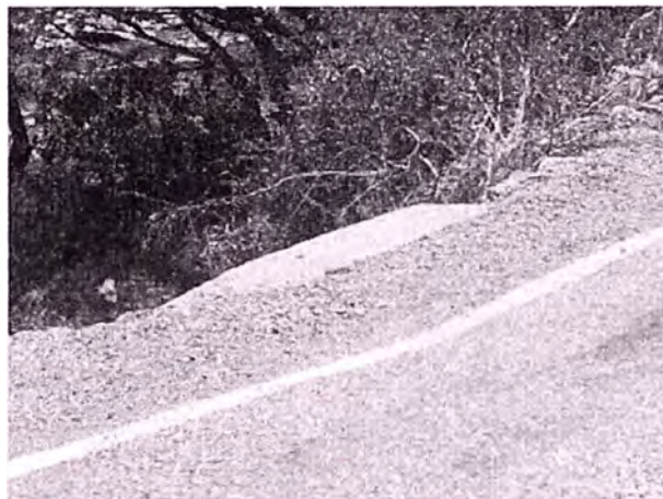
Figura N° 3.01: Hundimiento por mal proceso constructivo
