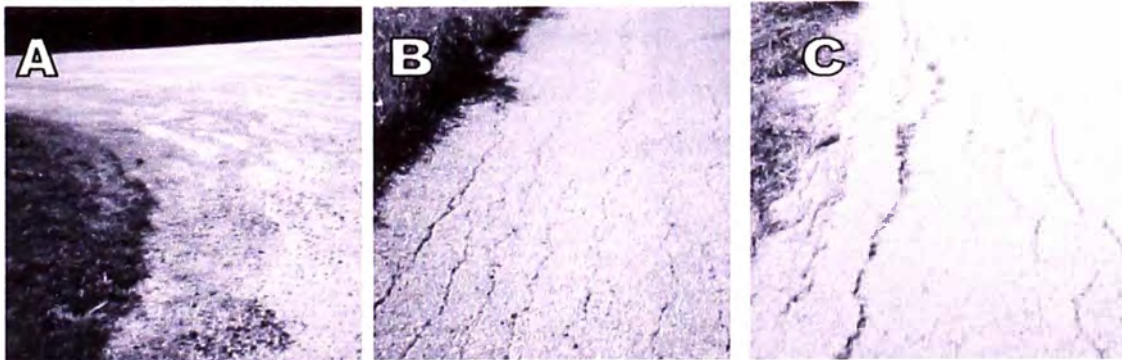
Figura N° 4.04: Ejemplo grieta de borde
