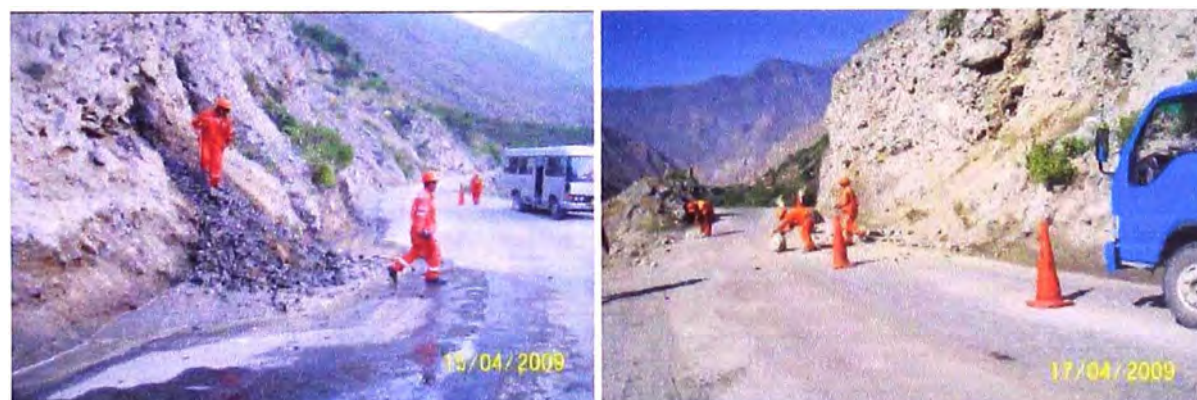
Figura N° 5.03: Limpieza de derrumbes menores
