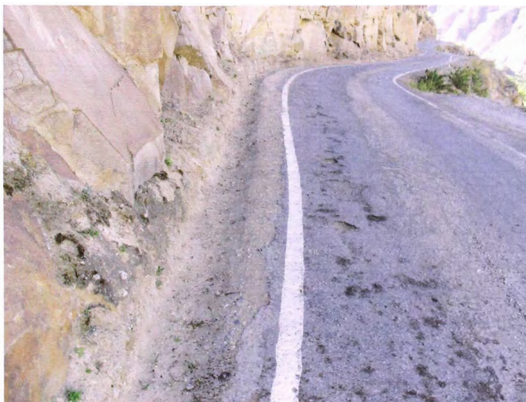
Foto N°06: No hay cunetas, geometría peligrosa, baches, no hay borde de vía
