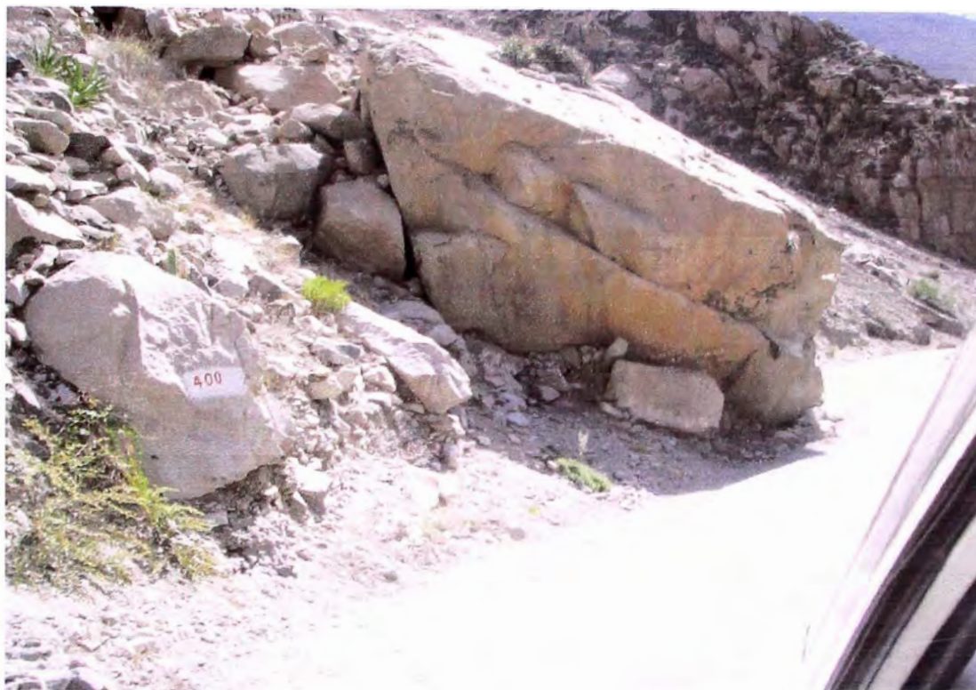
Foto N°05: Inestabilidad de taludes, no hay cunetas
