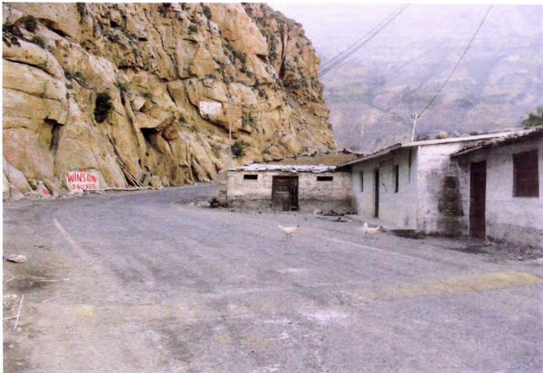
Foto N°04: No hay cunetas, giba en mal estado y la pintura desgastada
