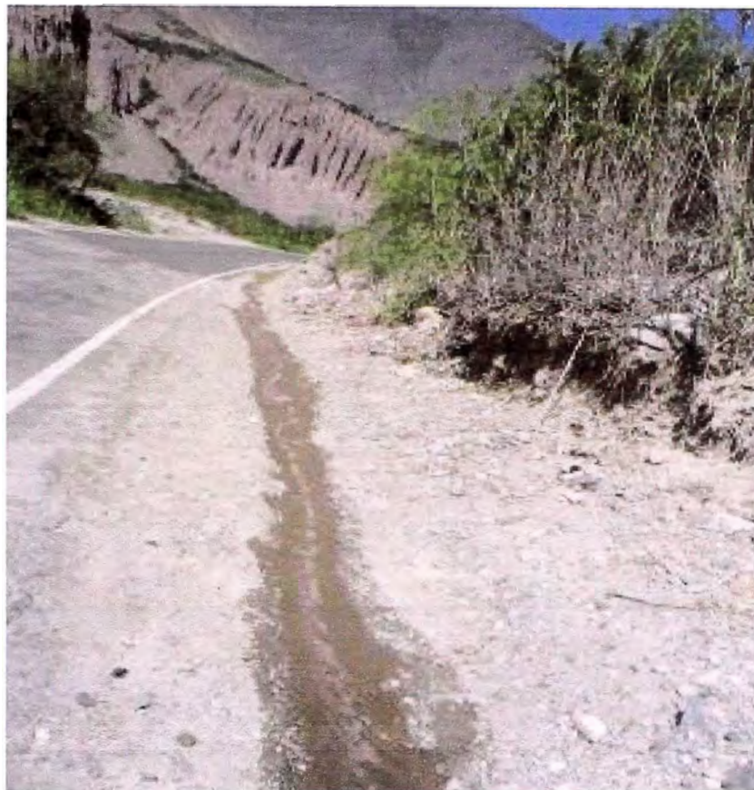
Foto N°09: Carpeta expuesta a la erosión del agua, cuneta natural
