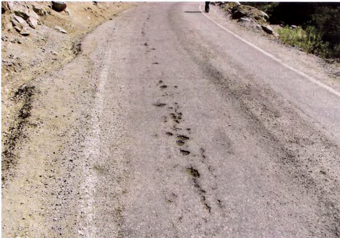
Foto N°07: No hay cuneta, pintura desgastada, bahces, desprendimiento del tratamiento superficial
