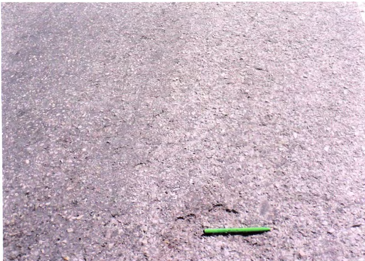
Foto N°02: Desgaste y formación de baches
