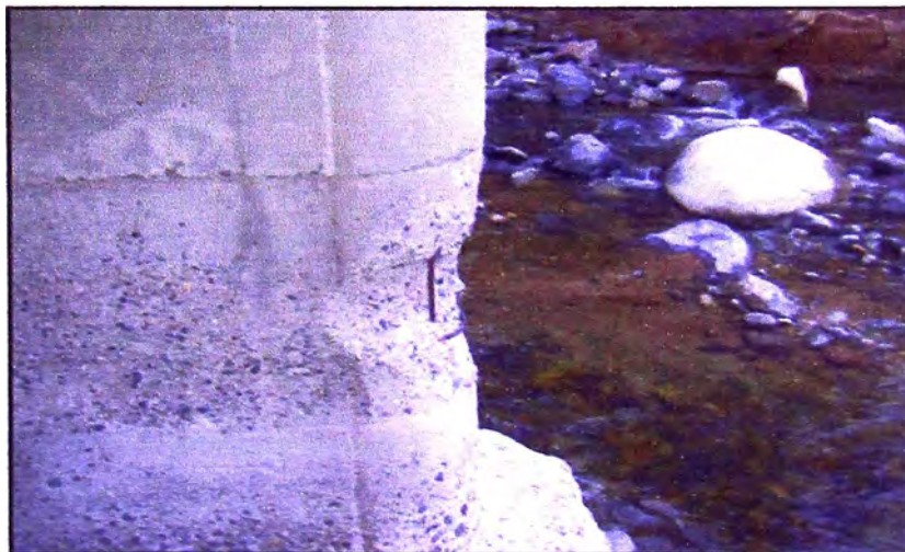
Figura Nº 3.3 Se aprecia la degradación del concreto del pilar
