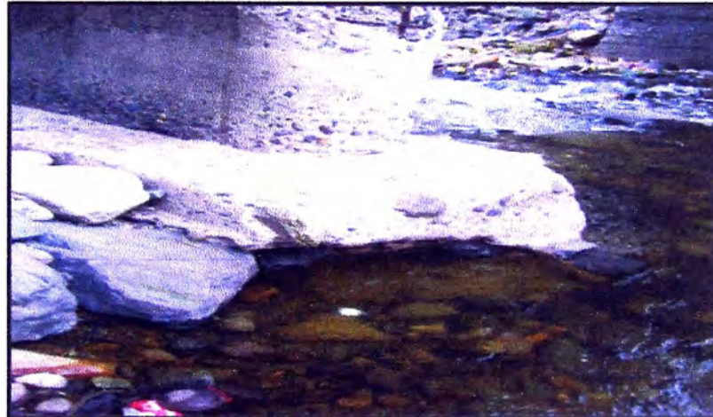
Figura 3.1, Fotos Socavación del pilar (Fuente: Libro Mecánica de suelos de Juárez Badilla-Rico Rodríguez)
