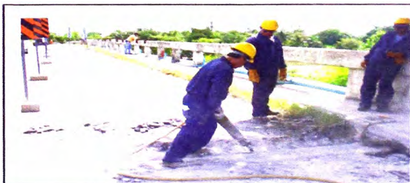
Figura 3.16. Demolición del tratamiento superficial y la losa de concreto (ejemplo de trabajos similares)
