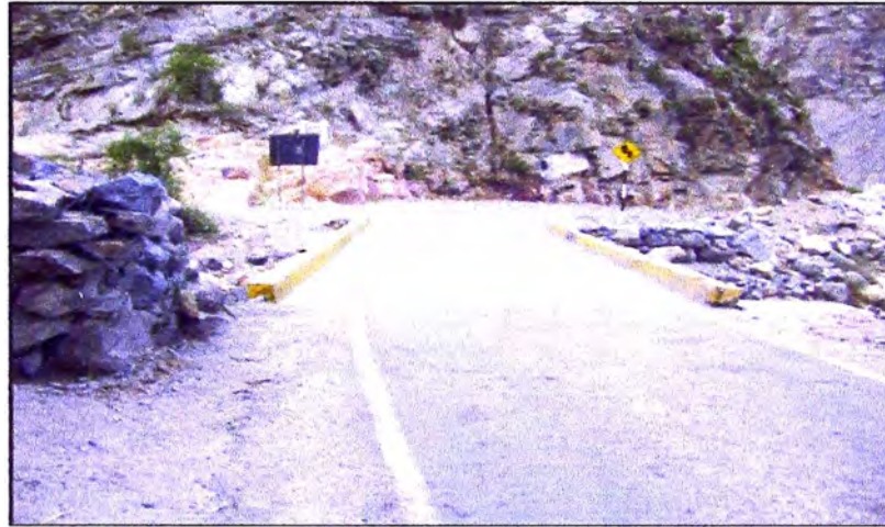
Figura N° 3.13, No tiene baranda el puente
