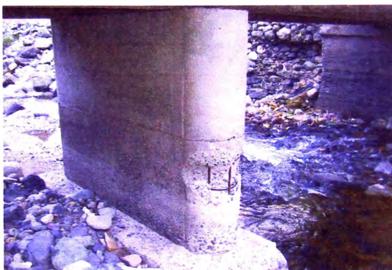
Figura N° 3.5 Necesita urgente resane con concreto y reposición del acero corroído.
