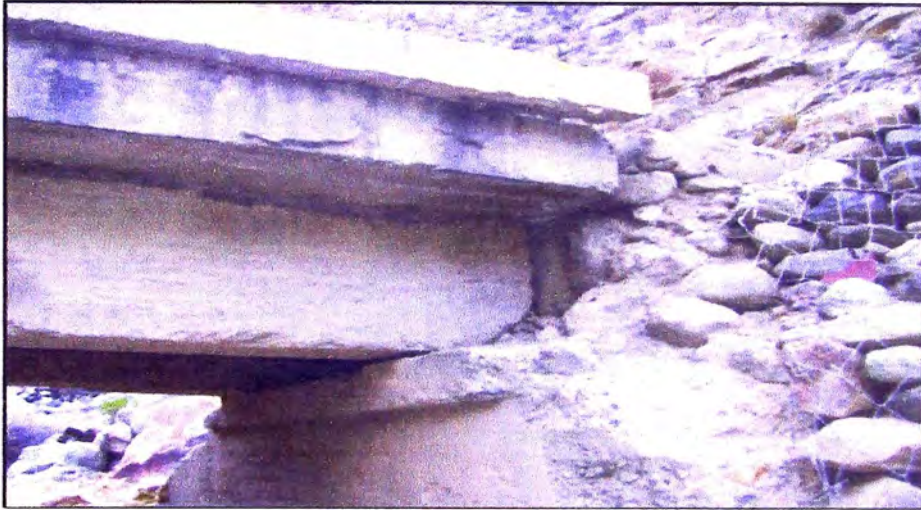
Figura N° 3.8, Ya los apoyos están Inoperativos del estribo
