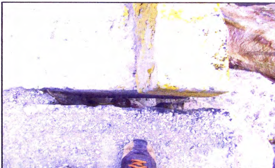
Figura Nº 3.15 No presenta junta de dilatación-Vista planta
