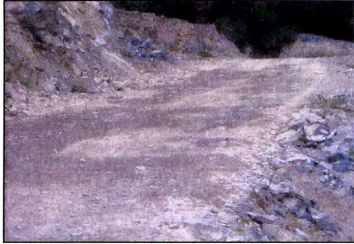
FIGURA 1.02 SUBRASANTE DETERIORADA CON AHUELLAMIENTOS Y ENCALAMINADOS KM 110
