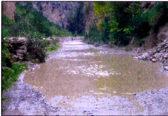
FIGURA 1.03 PRESENCIA DE BACHES PROFUNDOS EN EL KM 165
