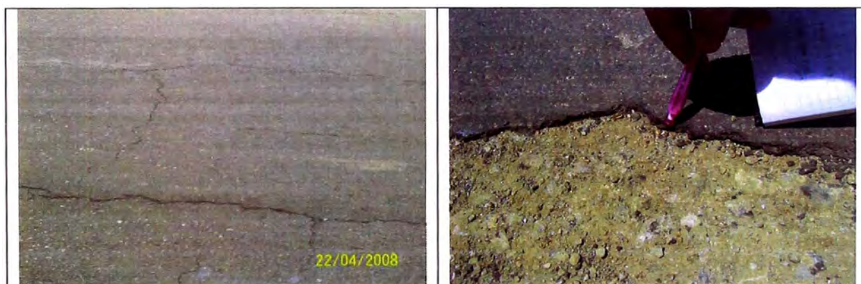
Daños superficiales en el tramo pavimentado, fisuras longitudinales y transversales y bordes de carreteras
