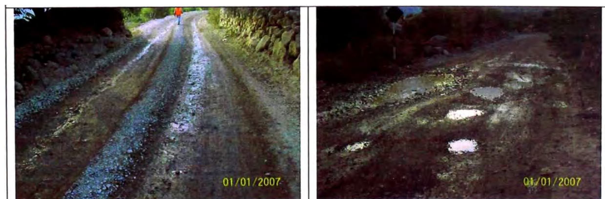
Daños superficiales tramo no pavimentado, foto 1- Ahuellamientos y foto 2- Huecos.
