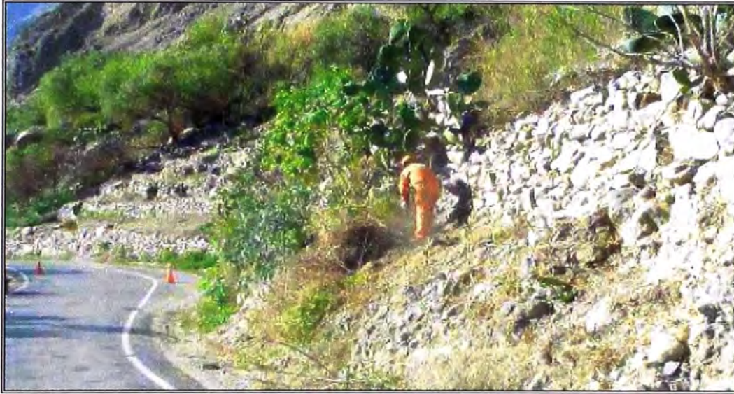
Figura N° 3.16 Poda de Vegetación que Obstruye la Visibilidad en la Vía
