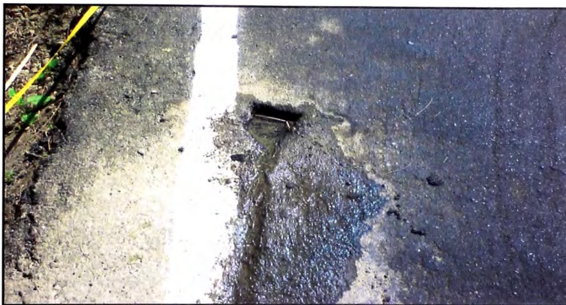
Figura N° 3.24 Bache con Presencia de Afloramiento de Agua
