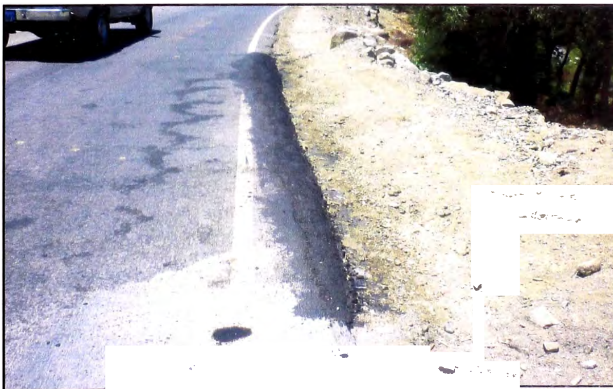
Figura N° 3.25 Fallas de Borde
