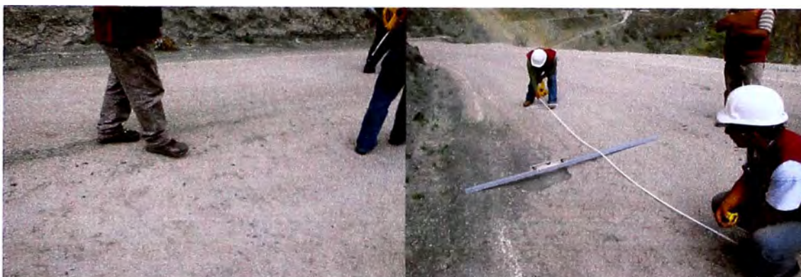
FOTO 3.30: Presencia de agrietamientos en la superficie del tratamiento monocapa, entre las progresivas Km. 134+000 al Km. 139+000.
