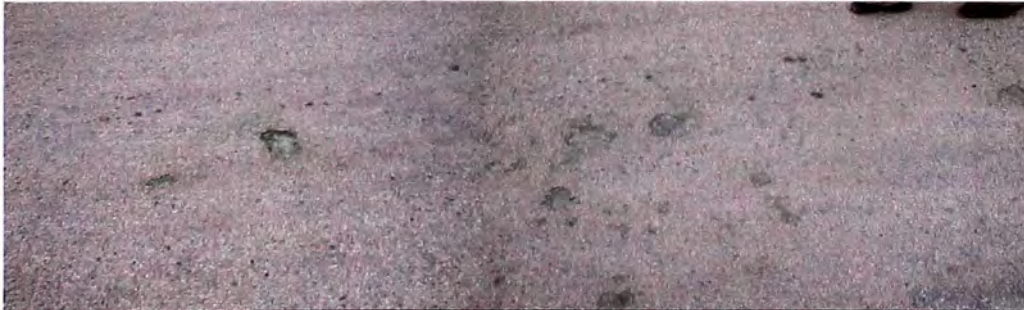
FOTO 3.25: Presencia de descascaramientos en la superficie del tratamiento monocapa, entre las progresivas Km. 134+000 al Km. 139+000.
