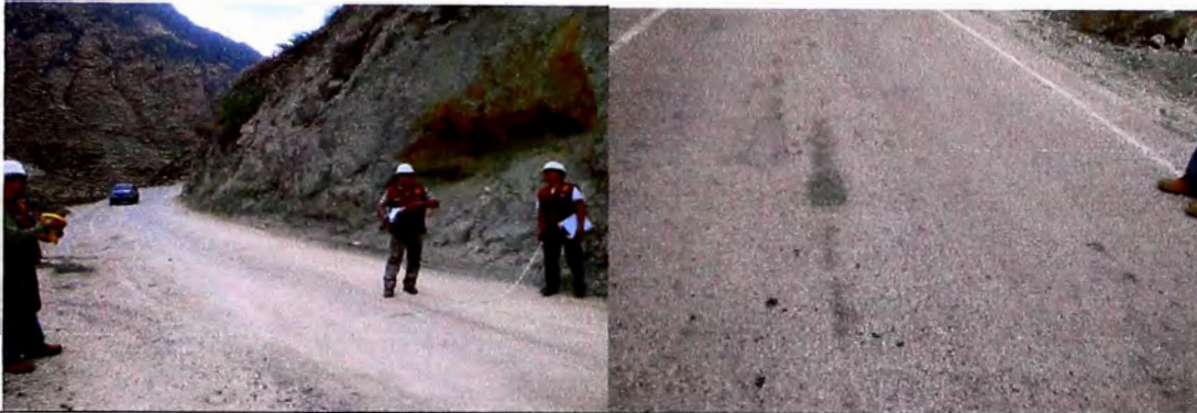
FOTO 3.27: Presencia de pérdida de ligante en la superficie del tratamiento monocapa, entre las progresivas Km. 134+000 al Km. 139+000.
