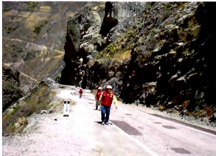
Daños más representativos Tramo Km 136+000 al Km 137+500
