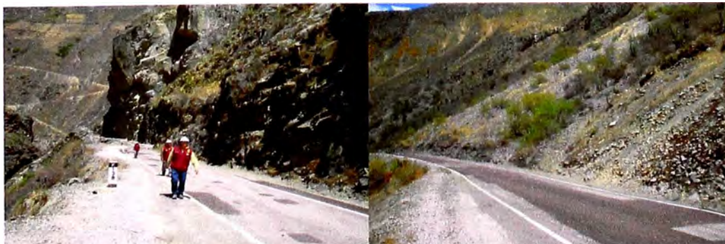
FOTO 3.23: Presencia de parcheos en la superficie del tratamiento monocapa, entre las progresivas Km. 134+000 al Km. 139+000.
