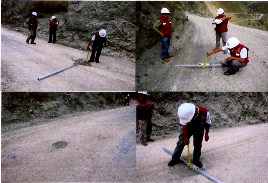
FOTO 3.24: Presencia de huecos en la superficie del tratamiento monocapa, entre las progresivas Km. 134+000 al Km. 139+000.
