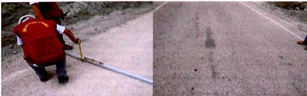
FOTO 3.26: Presencia de ahuellamiento en la superficie del tratamiento monocapa, entre las progresivas Km. 134+000 al Km. 139+000.
