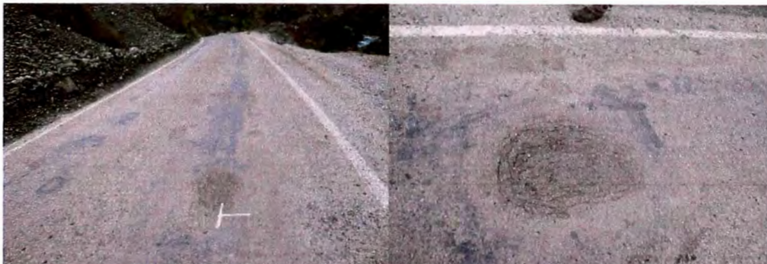
FOTO 3.28: Presencia de corrugaciones en la superficie del tratamiento monocapa, entre las progresivas Km. 134+000 al Km. 139+000.
