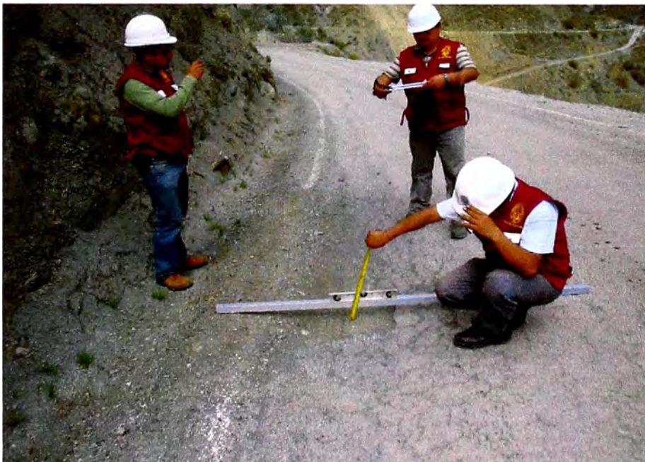
FOTO 02: Medición de la profundidad de los deterioros (huecos) en el Km 135+300 al Km 135+400
