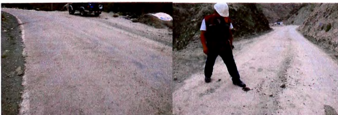
FOTO 3.29: Presencia de pérdida de agregados en la superficie del tratamiento monocapa, entre las progresivas Km. 134+000 al Km. 139+000.
