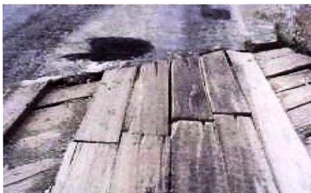
Foto 21 Acceso derecho carril izquierdo donde se observan tablones levantados
