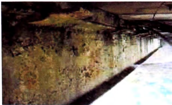
Foto 28 Vista de la viga central tomada del estribo izquierdo donde se observa el que no funciona la union de la viga con la madera
