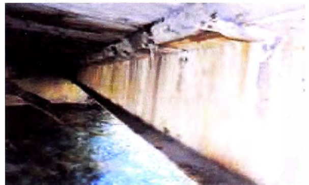
Foto 27 Vista de la viga del extremo derecho tomada del estribo izquierdo donde se observa el mal estado de la union de la viga con la madera
