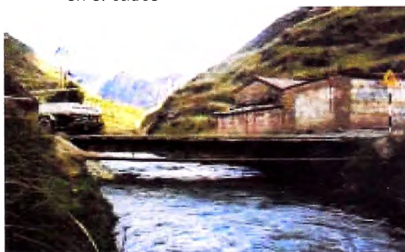
Foto 11 Vista de cauce aguas arriba donde se observa una tubería de fierro de agua
