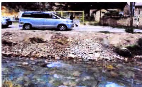
Foto 09 Vista de cauce aguas abajo donde se observa que se esta vertiendo desmonte en el cauce
