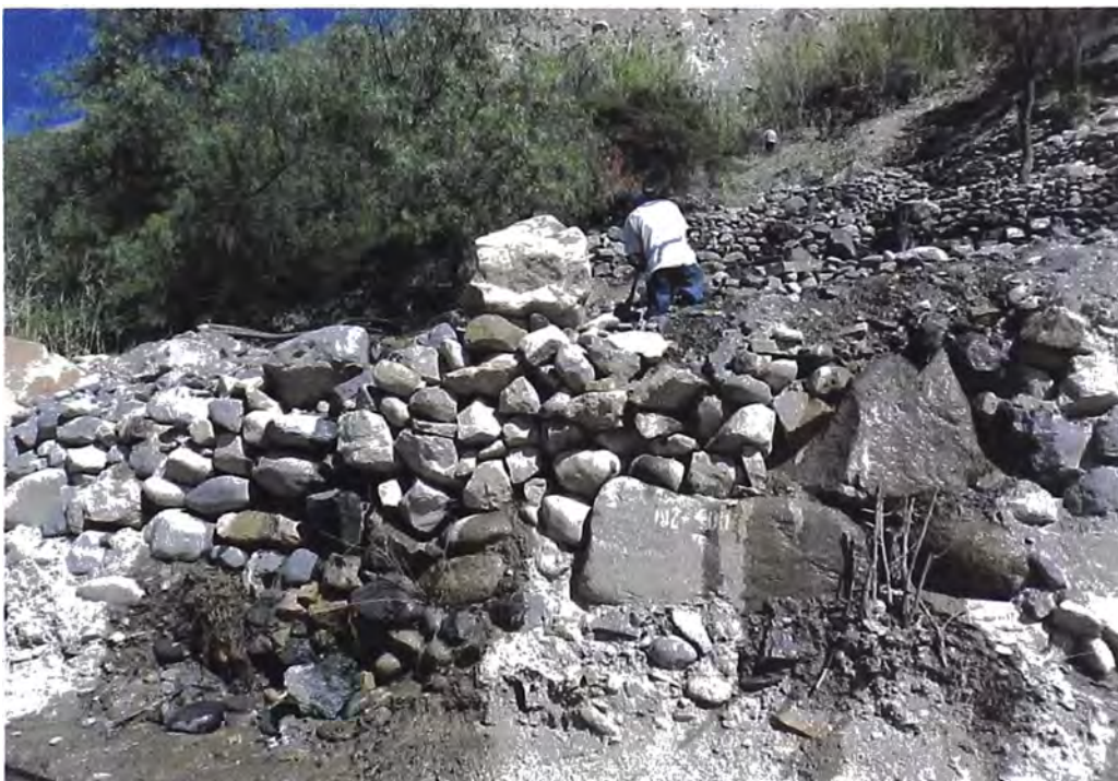
Fotografías mostrando Falta de drenaje de coronación - Km. 102+400
