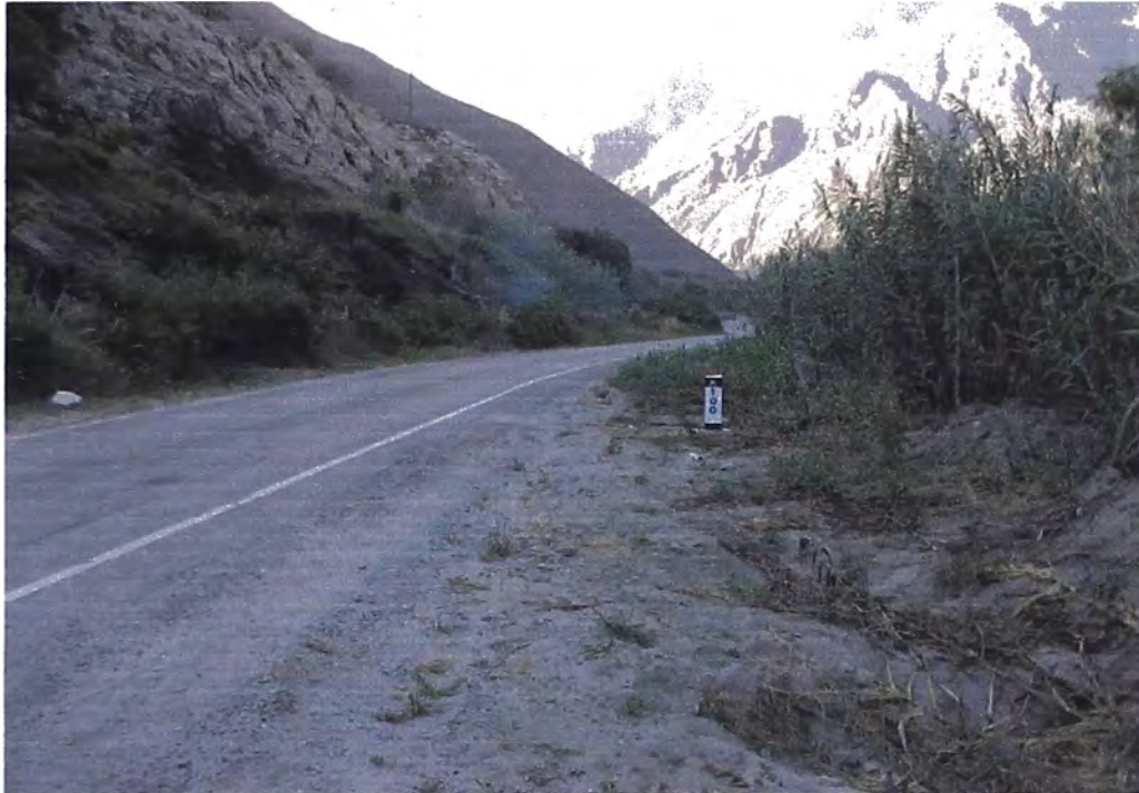
Fotografía mostrando cunetas obstruidas Km. 100+00
