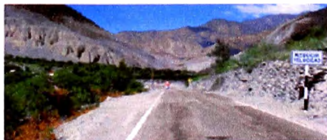
Señal inadecuada Km. 101
