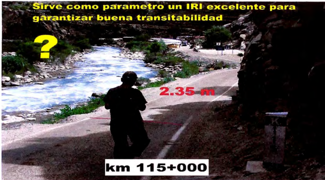
Figura N° 2.03 Sector sin berma, falta cunetas y ancho insuficiente
