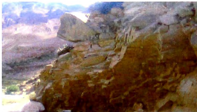
Figura N° 2.11 Peligro inminente, caída de roca Km. 115+000
