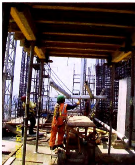
Figura 6: Retiro del elevador VR
