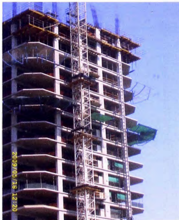
Figura 13: Mallas anticaida colocado en dos niveles
