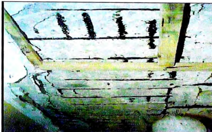
Figura 2-1: Alteración del concreto
