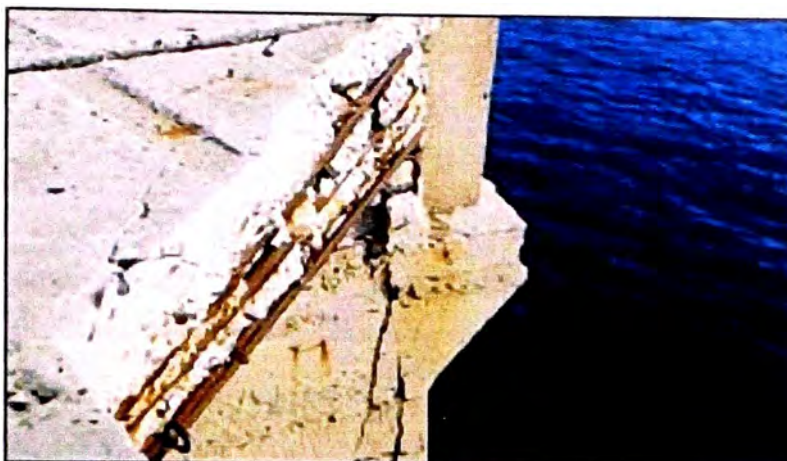
Figura 2-2: Corrosión de armaduras
