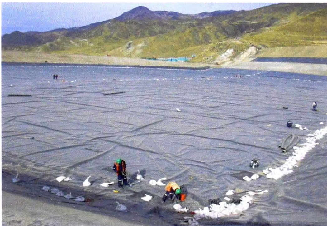
Fotografía N° 3 : Revestimiento con Geomembrana de la Etapa Pre-Inicial. El despliegue se ha concluido y se terminan los trabajos de soldadura.
