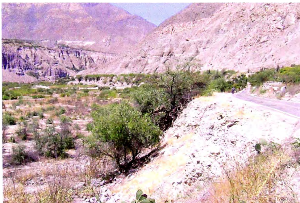
KM 102+600 – TALUD VULNERABLE A LA EROSION EN EPOCA DE CRECIDA DEL RIO
