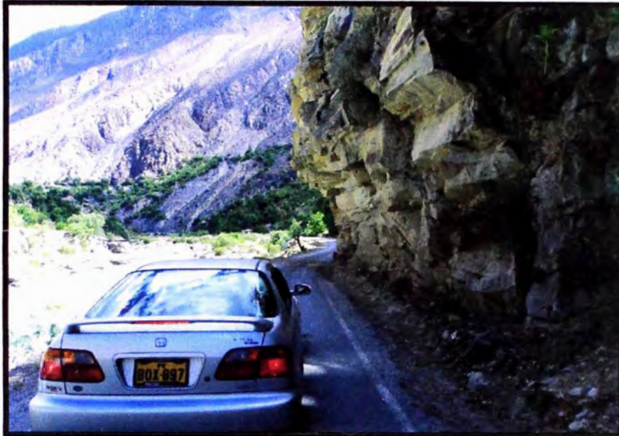
Foto N° 05 Km 115+00 Inestabilidad de taludes-talud con roca fracturada
