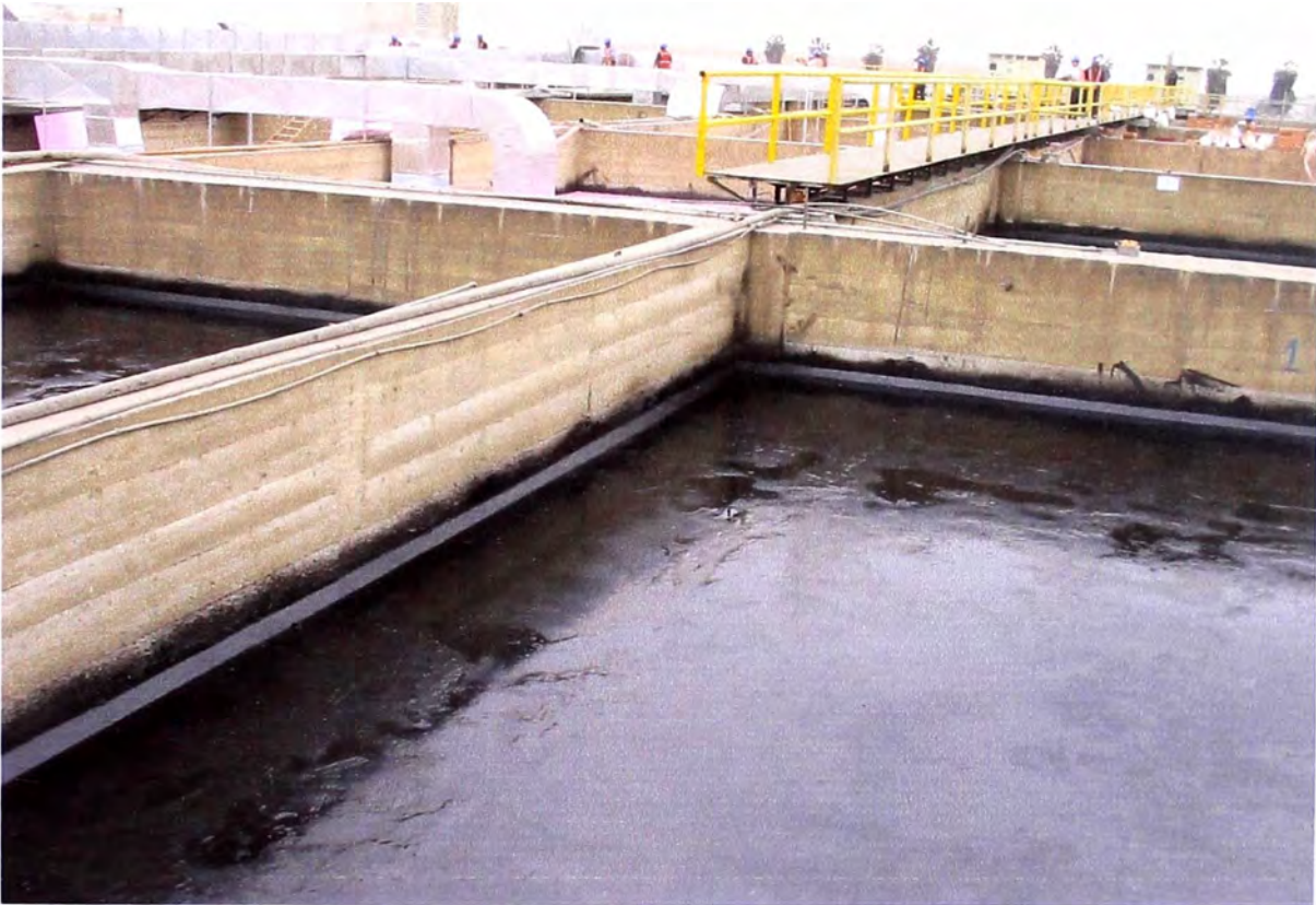
Foto N° 03 - Impermeabilización.- Piscinas impermeabilizadas con emulsión asfáltica de rotura rápida 2P. Nótese que la faja en chaflán también ha sido impermeabilizada para impedir que por esta pueda filtrar cualquier tipo de líquido.
