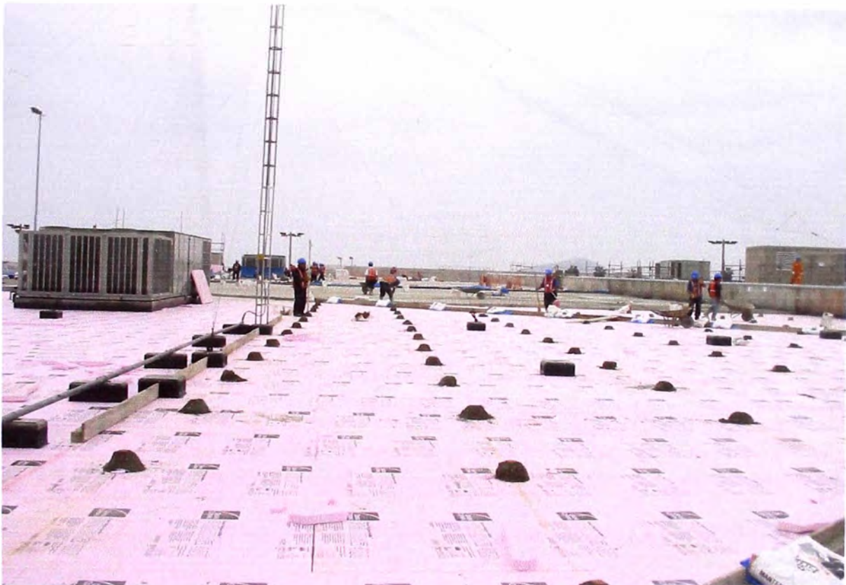
Foto N° 06 - Nivelación para vaciado de concreto.- Con el fin de controlar los niveles y pendientes de drenaje, se colocó puntos topográficos como referencia para los albañiles encargados de colocar el concreto ligero.
