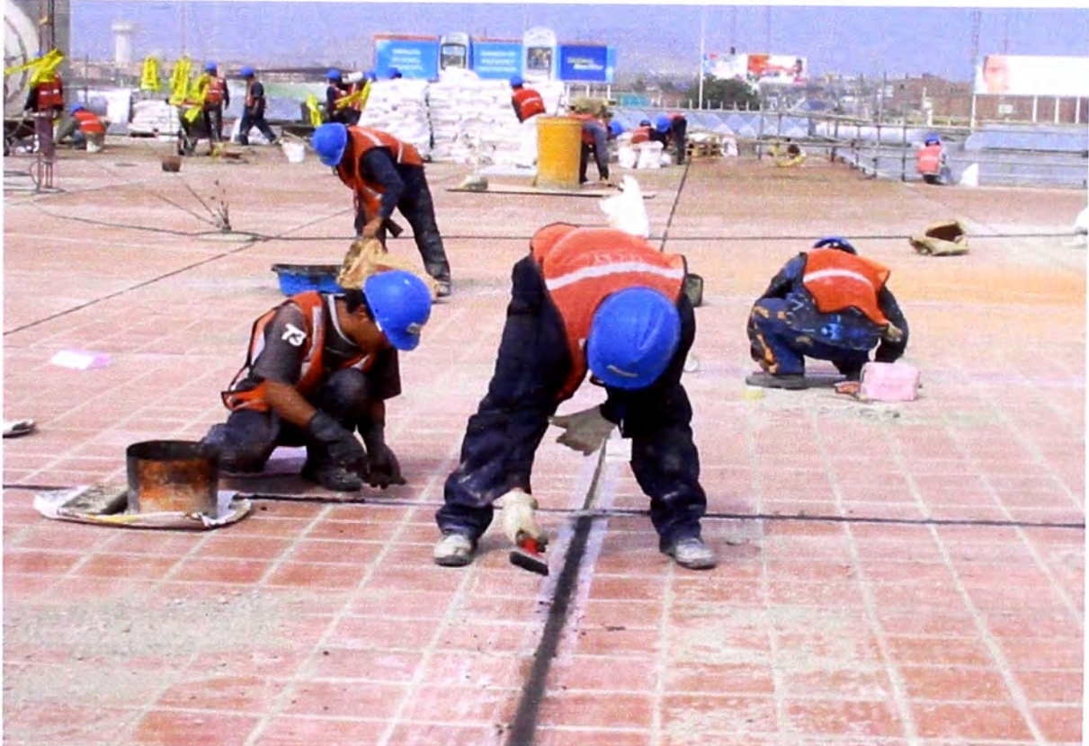
Foto N 11 - Instalación de juntas de dilatación.- Se ejecutó cada 3 mts en ambos sentidos, con una mezcla de emulsión-arena.
