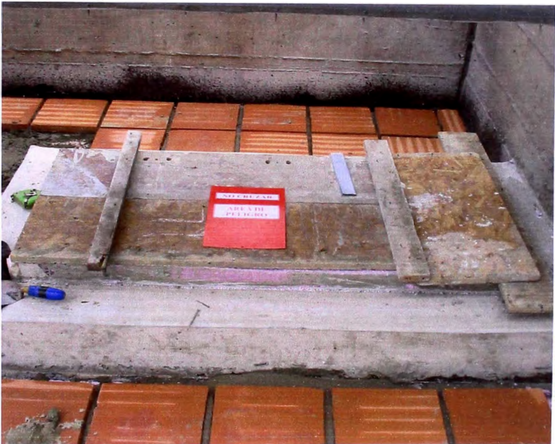
Foto N° 13 - Ductos de aire acondicionado.- Requirieron de un tratamiento especial con bolsas de plástico selladas herméticamente para evitar cualquier tipo de obstrucción en el interior de los equipos de aire acondicionado.
