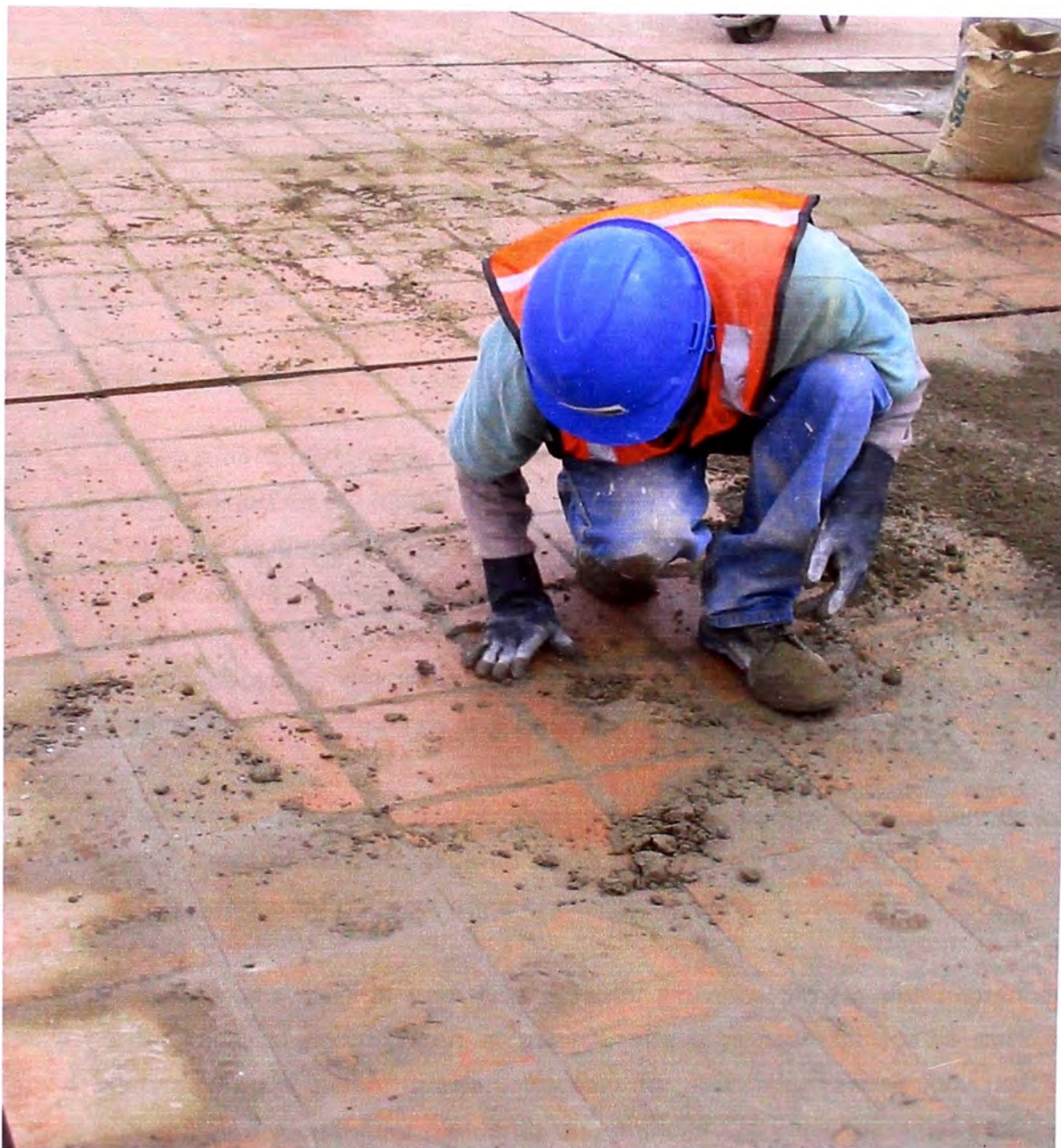
Foto N 10 - Fraguado de ladrillo pastelero.- Después del asentado del ladrillo pastelero se procede a la fragua del mismo. Esta fragua se realiza con mezcla de arena-cemento.
