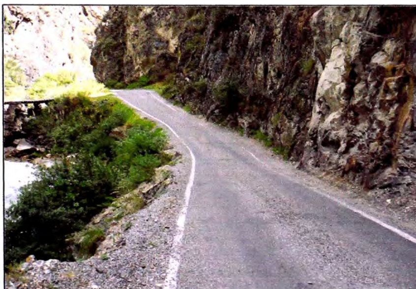
Figura N° 2.05: Carretera Cañete-Huancayo, km 162+200, ancho de la plataforma menor a 3m
