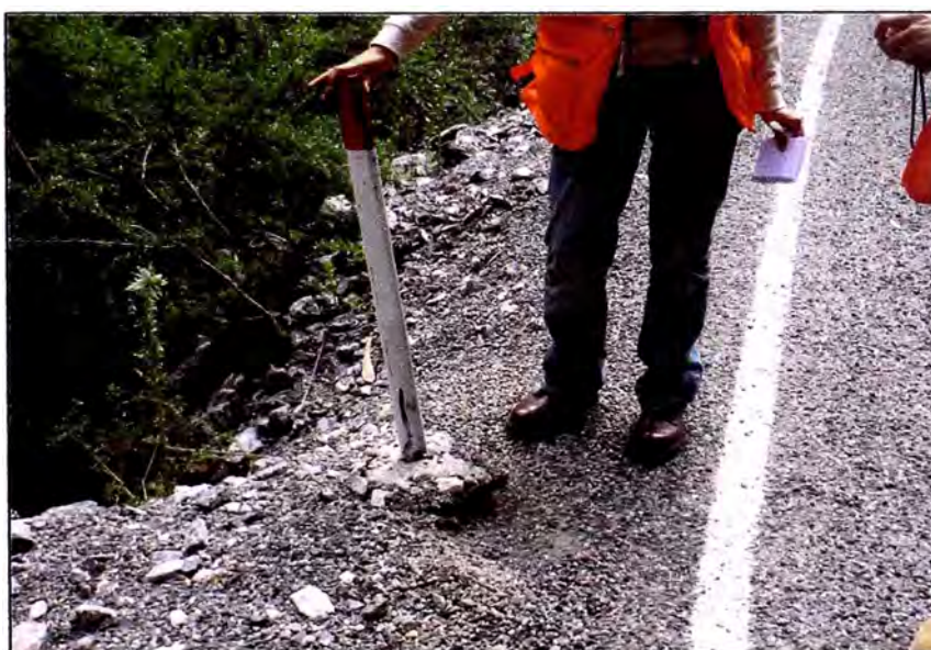
Figura N° 2.23: Poste delineador con cimentación superficial, km 171+800 LI
