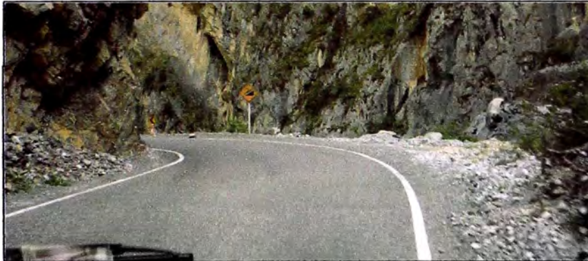
Figura N° 2.26: Curva peligrosa, km 168+450 LI
