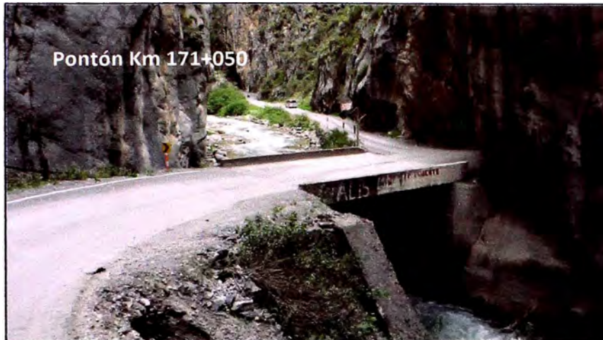
Figura N° 2.29: Continuación, Alcantarilla y Pontón sin recubrimiento con pintura
