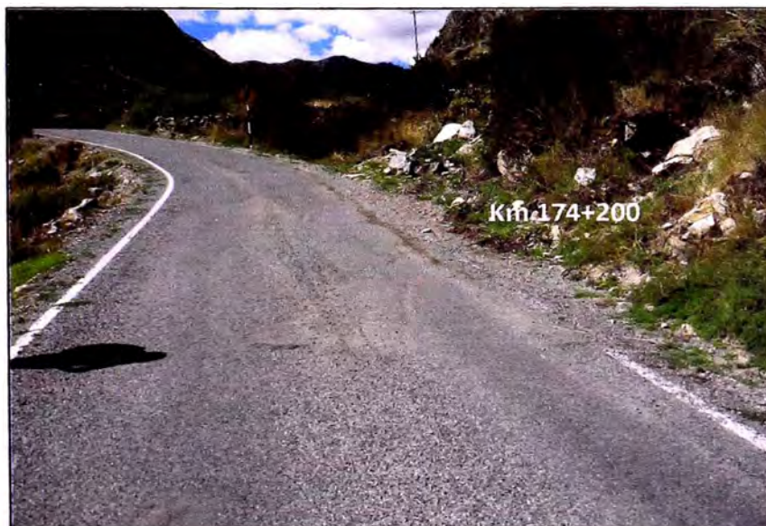
Figura N° 2.27: Pintura de borde cubierta y despintada
