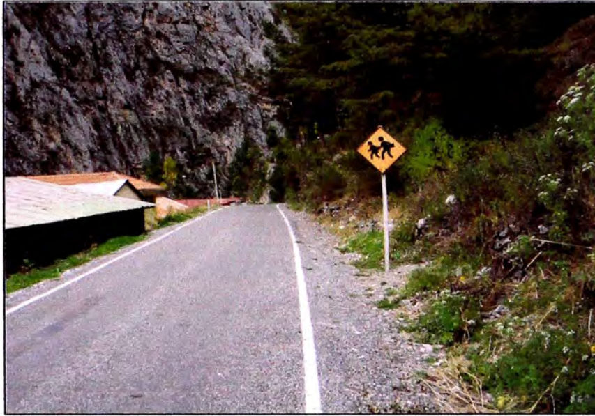
Figura N° 2.9: Carretera Cañete-Huancayo, km 172+600 LI
