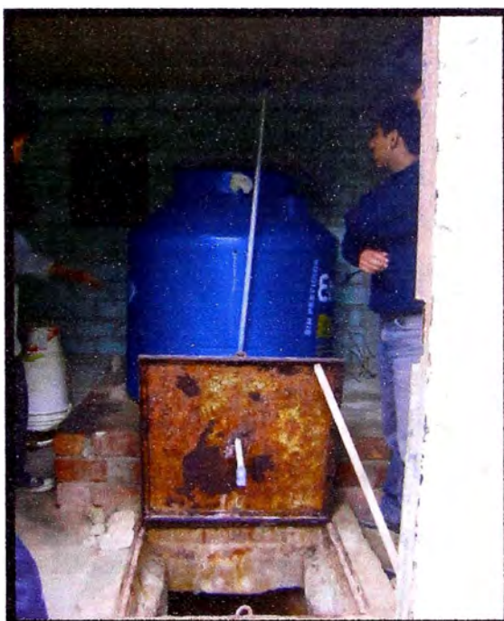
Figura 1.4: Estructura de captación y cloración por goteo
