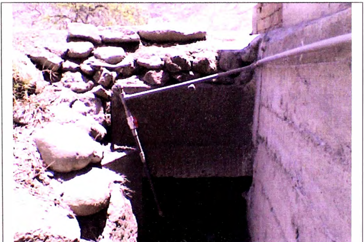
Foto N° 8: Se observa las conexiones domiciliarias que pasan por la parte interior de las alcantarillas de la carretera.
