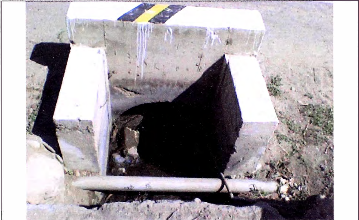
Foto N° 7: Se observa las conexiones artesanales existentes en la actualidad, los cuales ocasionan fugas de agua y pérdidas de presión afectando la red de agua potable.
