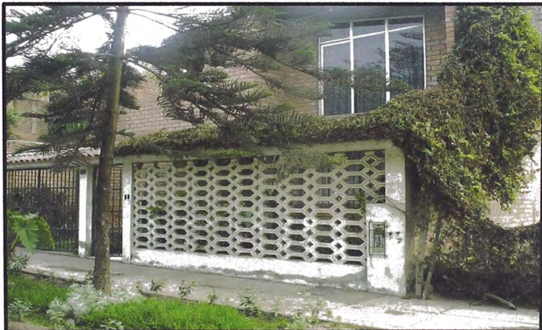
Vivienda afectada por problemas de corrosión Vista frontal
