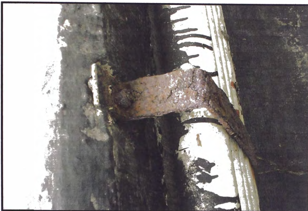
Fig. 3 Muestra la corrosión en el muelle de Ancón
