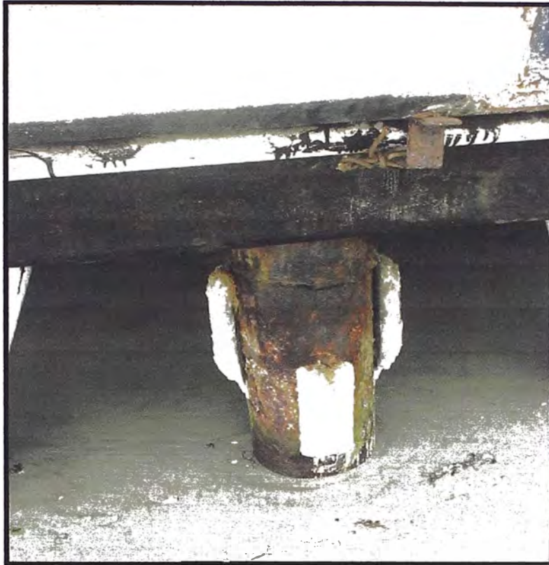
Fig.26 Pilar corroído por los agentes agresivos (sulfatos).
