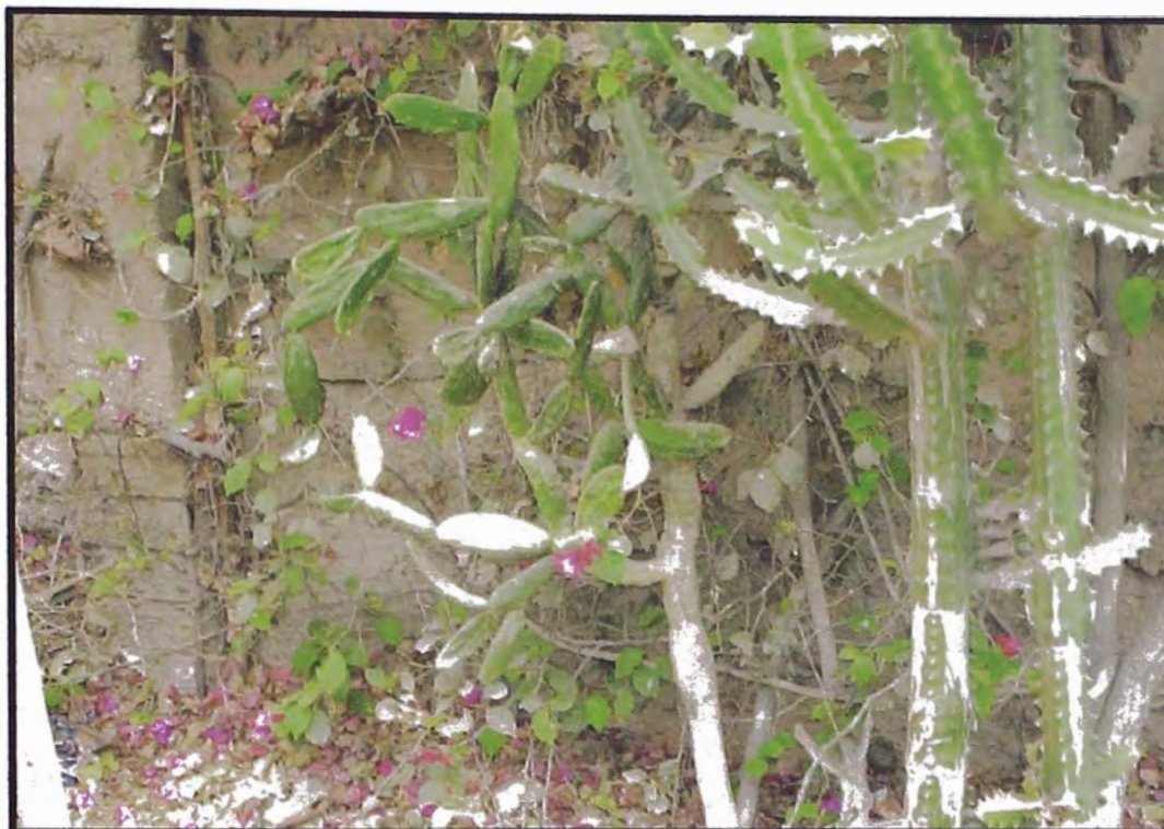
Fig. 16 La base de la estructura presente fallas por corrosión debido a la constante humedad
