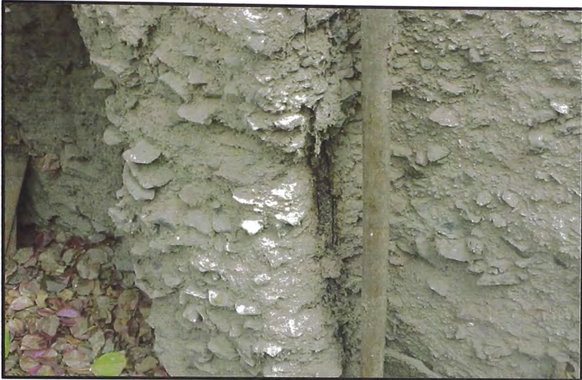
Fig. 18 Humedad , microorganismos y la mala calidad del concreto causantes del fenómeno de corrosión (muestra el desprendimiento del concreto).
