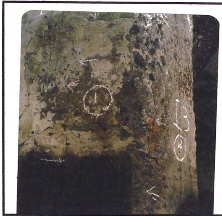
Fig. 24 Pilote con problemas de corrosión
