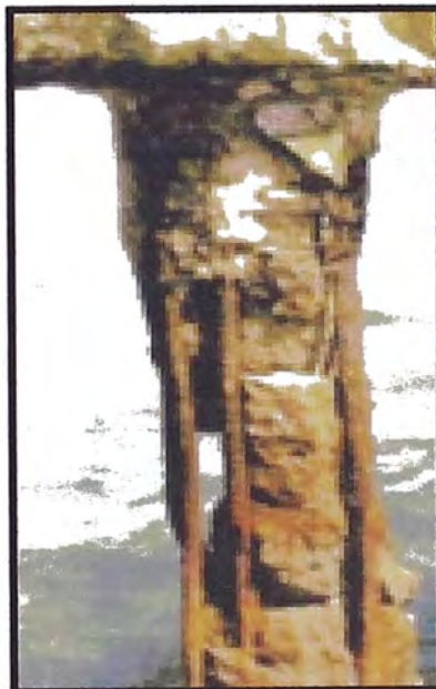
Fig. 6 Muestra la corrosión de una estructura de concreto
