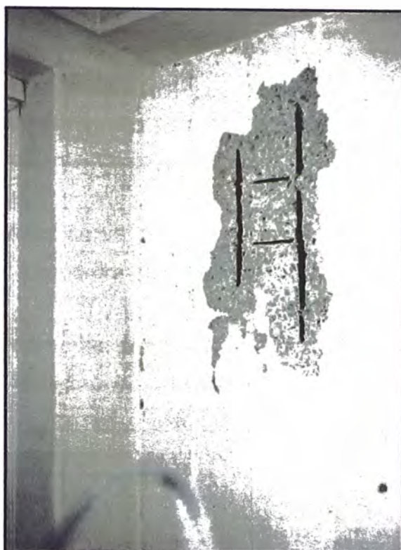
Fig. 2 Se aprecia el problema de corrosión en el interior de una vivienda
