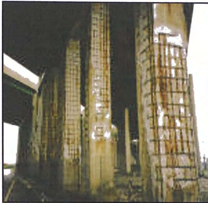
Fig. Muestra la corrosión uniforme toda la estructura esta afectada uniformemente
