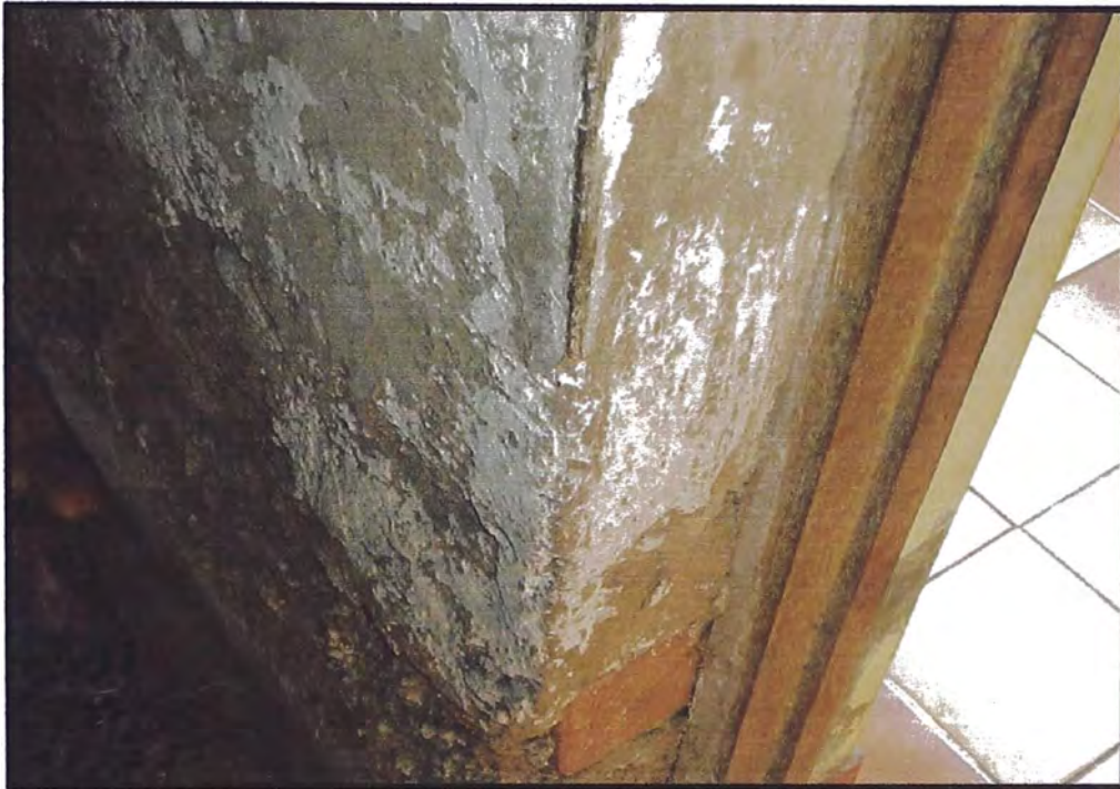
Fig. 20 Corrosión del concreto debido a la humedad
