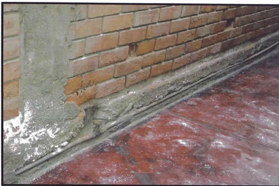
Fig. 21 Humedad debido a las filtraciones, causaron el problema de la corrosión.
