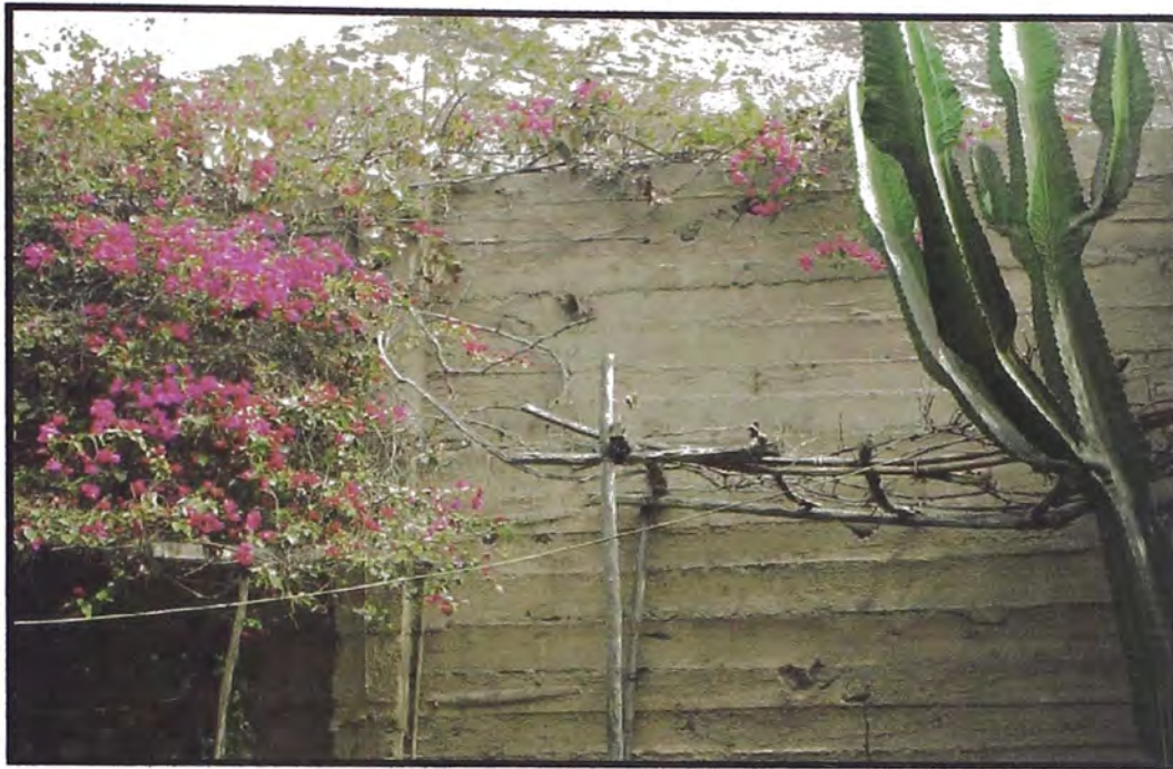
Fig. 15 Muro de contención con fallas de corrosión
