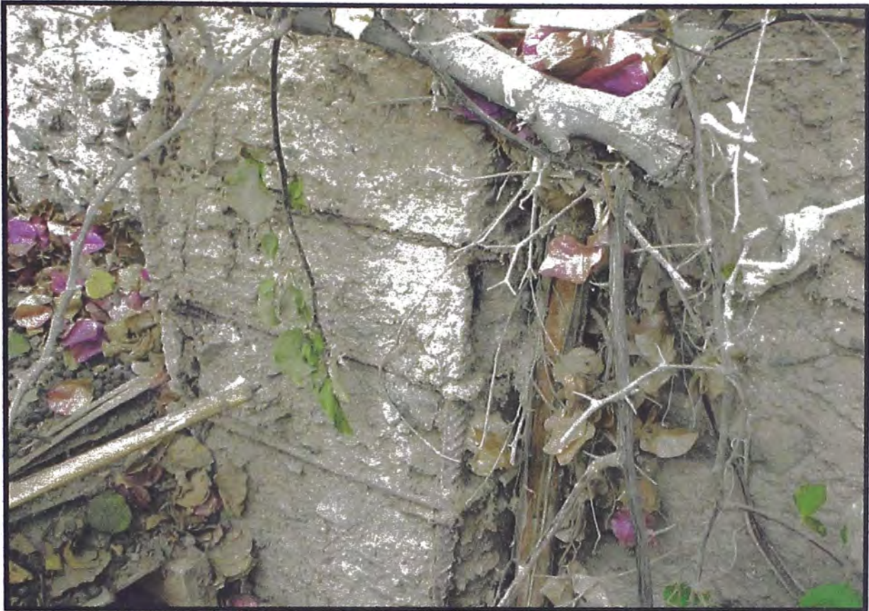
Fig. 17 Columna descubierta debido al proceso de carbonatación y al pobre tipo de mezcla
