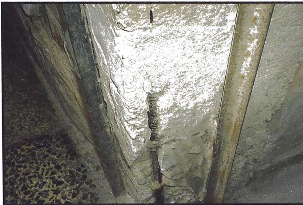
Fig. 19 Pérdida de recubrimiento del concreto
