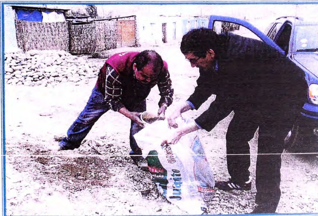
Foto N ° 8: Vista panorámica, se observa la toma de muestra en la calicata C4 para realizar ensayos Proctor de los suelos granulares encontrados.
