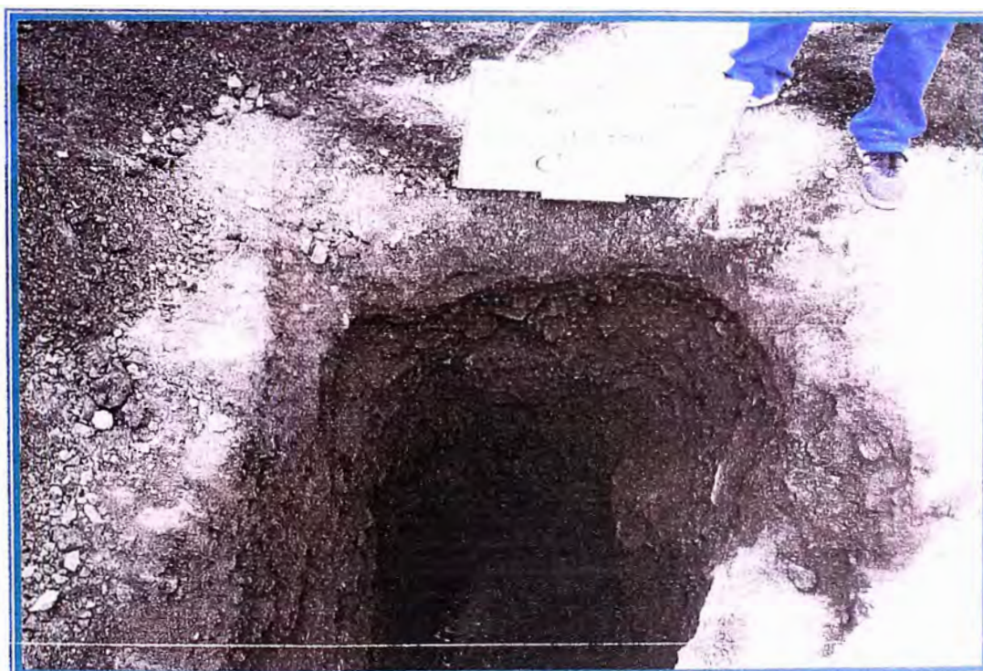
Foto N ° 22: Vista del interior de la calicata C10, observándose los suelos granulares encontrados.
