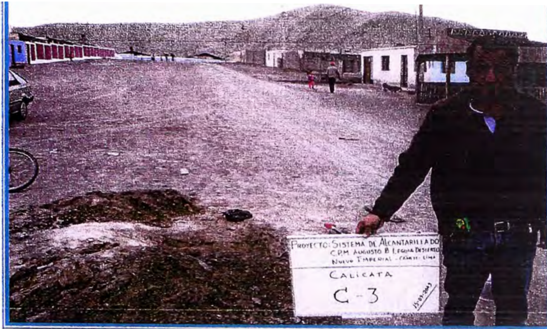
Foto N° 3: Vista panorámica de la ubicación de la calicata C3, observándose los suelos encontrados.
